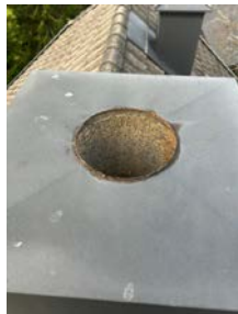
Manglende toppbeslag på pipe.
