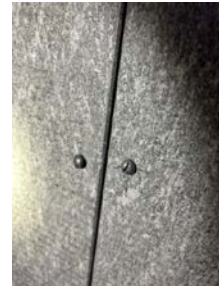
Plater av ukjent materiale. Asbest kan ikke utelukkes.
