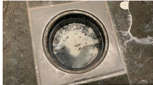
Sluk i dusjsone.
