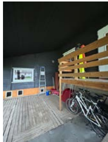
Rekkverk med mangler i forhold til dagens krav.
