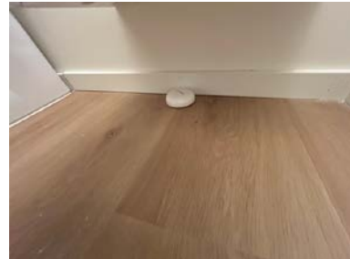
Lekkasjevarsler er montert.
