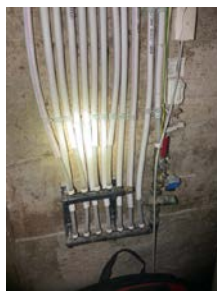
Fordelerstamme for rør-i-rør system uten sikker avrenning til sluk.
