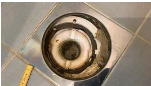
Sluk i dusjsone.
