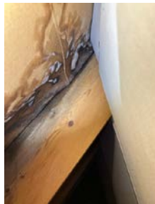
Fuktskader ved overgang knevegg og tak. Skjulte skader kan ikke utelukkes. Bilder fra befaring 13.11.2025.
