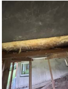
Vindtette plater under innglasset terrasse som har løsnet fra underlaget.
