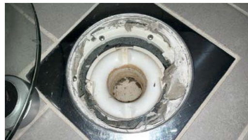
Sluk under servantskap.
