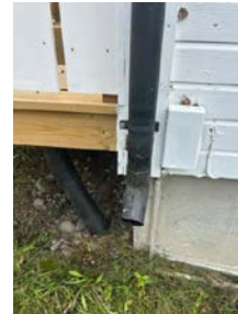
Mangelfull bortledning av vann fra grunnmuren.
