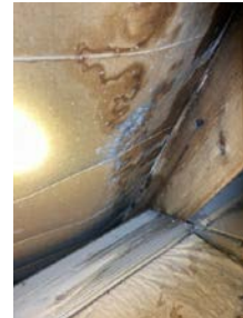
Fuktskader på undertak og takstol. Bilder fra befaring 13.11.2025.
