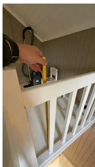
Rekkverkshøyder er under dagens forskriftskrav til rekkverk i trapper.
