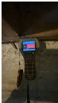
Ved enkel fuktmåling registrerte jeg skadelig fukt.
