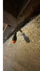
Det er registrert symptom på sopp/råte i etasjeskiller.
