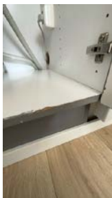
Fuktskjolder/svelling i bunnplate i benkeskap.
