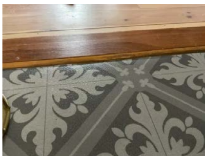
Manglende tettesjikt ved terskel.
