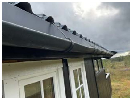
Skader og ujevnheter i takrenner.
