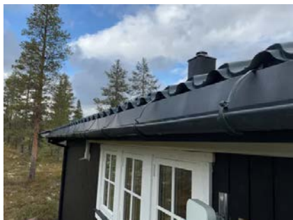
Skader og ujevnheter i takrenner.
