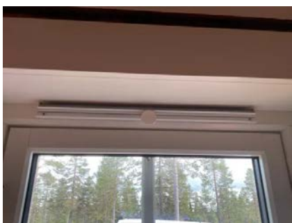
Ventil i vinduer.
