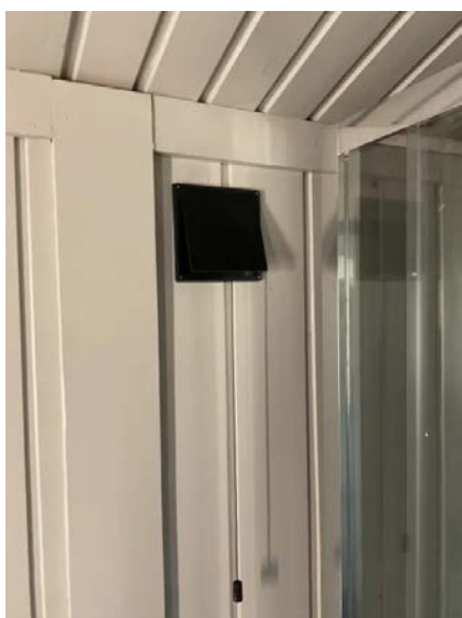
Ventil i vegg.
