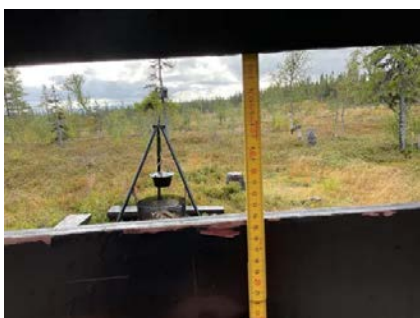
Åpning i rekkverk.
