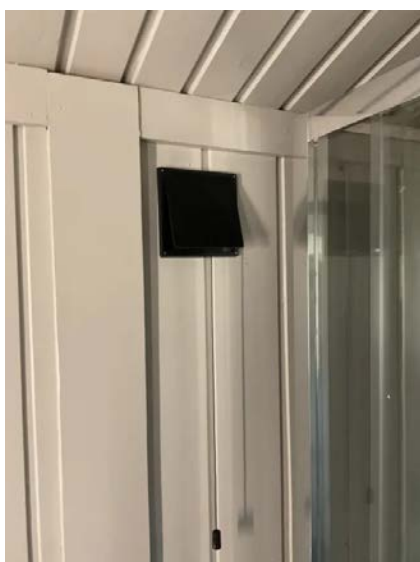
Ventil i vegg.
