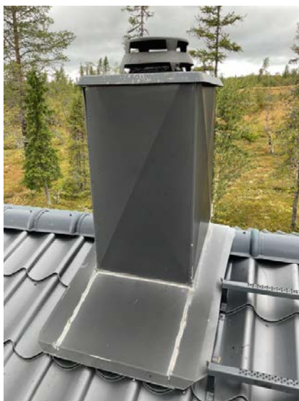
Pipe over tak.
