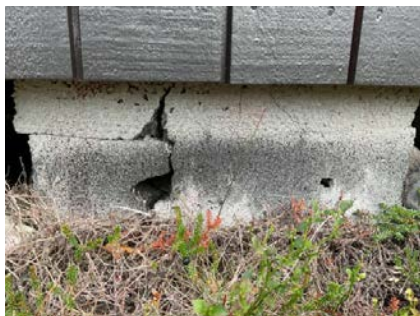
Sprekker i fundament.
