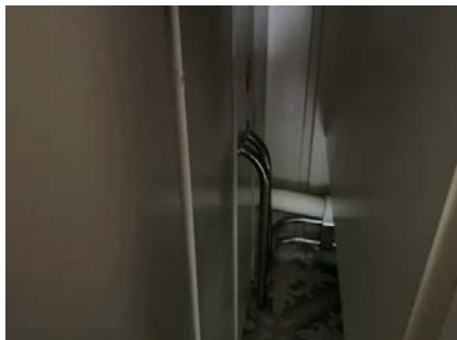
Manglende tetting rundt rørgjennomføring i vegg.
