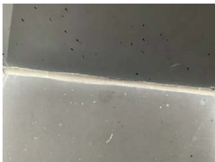
Sprekker i fuge på pipehatt.
