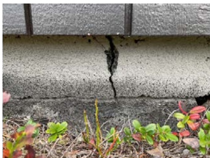
Sprekker i fundament.
