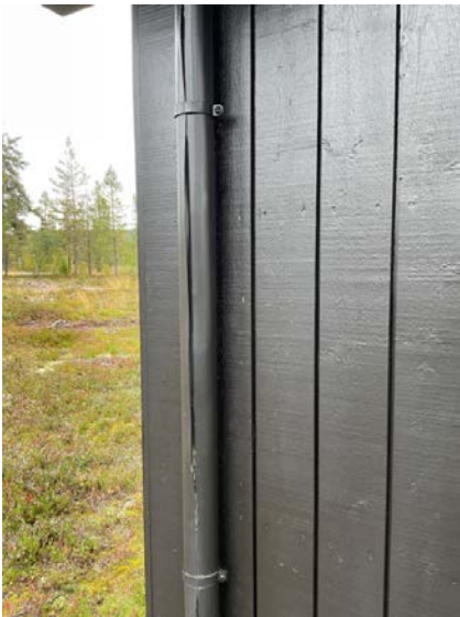
Fostspreng i nedløp.
