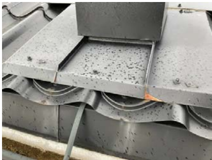
Rust på beslag.
