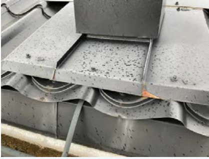
Rust på beslag.
