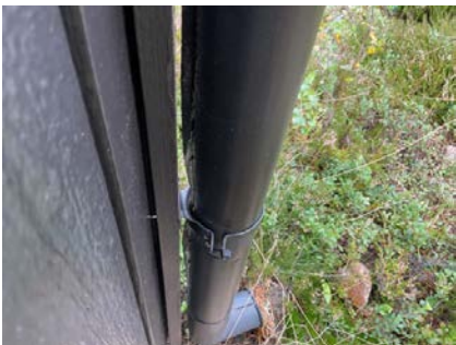
Fostspreng i nedløp.
