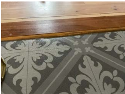
Manglende tettesjikt ved tersel.
