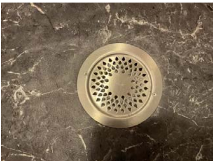
Sluk i teknisk rom.
