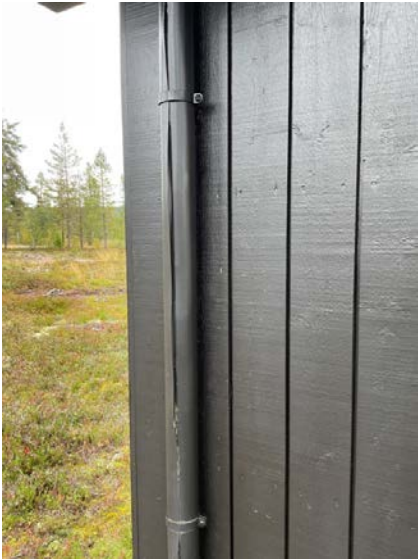
Fostspreng i nedløp.
