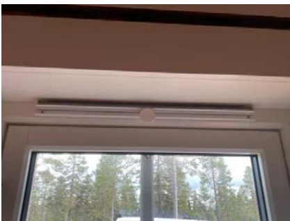
Ventil i vinduer.
