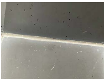
Sprekker i fuge på pipehatt.
