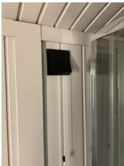
Ventil i vegg.
