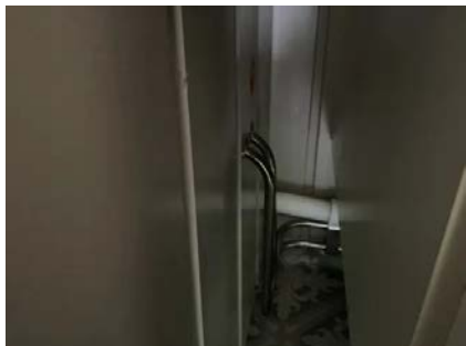
Manglende tetting rundt rørgjennomføring i vegg.
