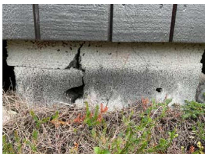
Sprekker i fundament.
