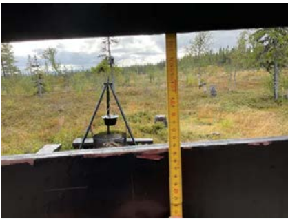
Åpning i rekkverk.
