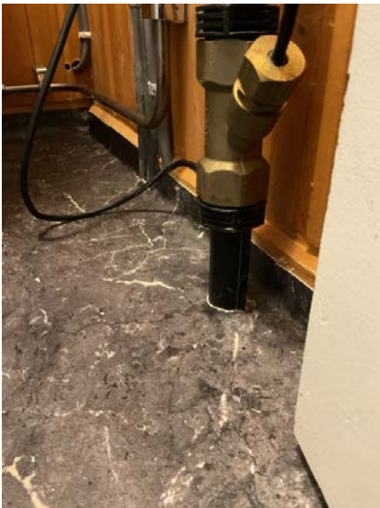
Gjennomføringer i gulv.
