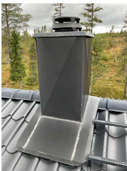
Pipe over tak.
