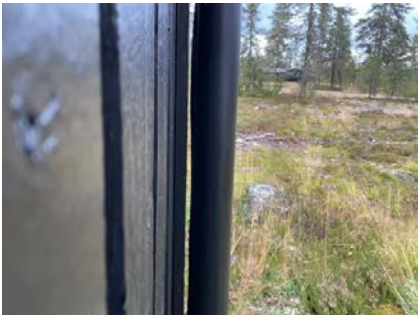
Fostspreng i nedløp.
