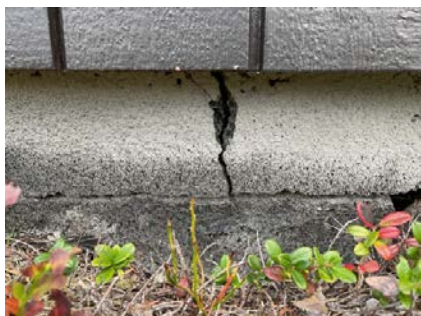
Sprekker i fundament.
