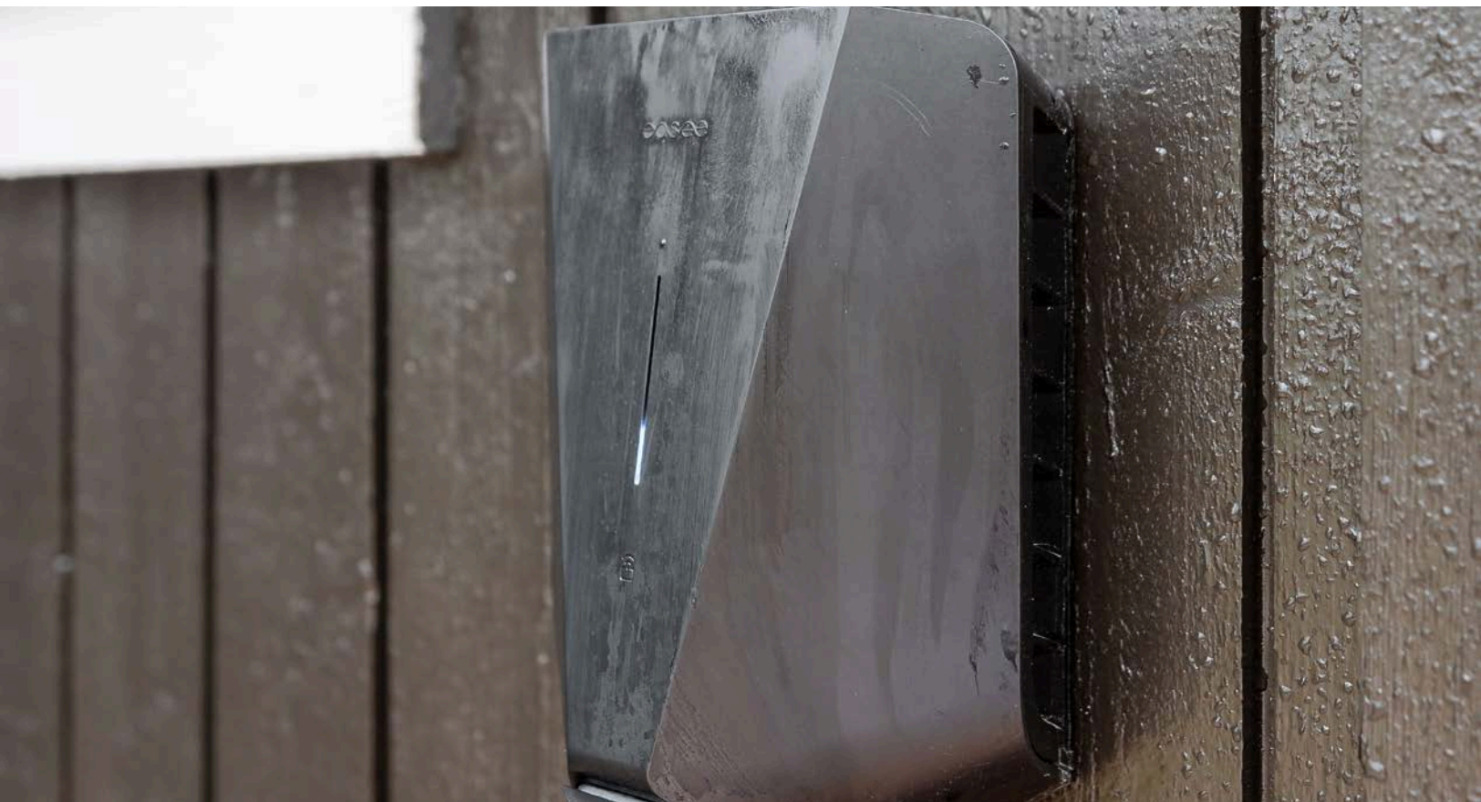
Montert el-billader gir praktisk mulighet for lading av elektriske kjøretøy.
