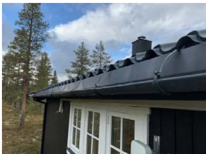
Skader og ujevnheter i takrenner.
