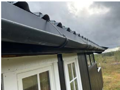
Skader og ujevnheter i takrenner.
