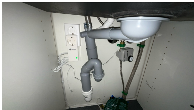
Synlige rør under kjøkkenbenken.
