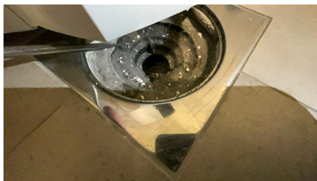
Plastsluk i gulv.
