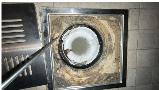
Plastsluk i gulv.
