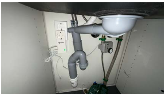
Synlige rør under kjøkkenbenken.
