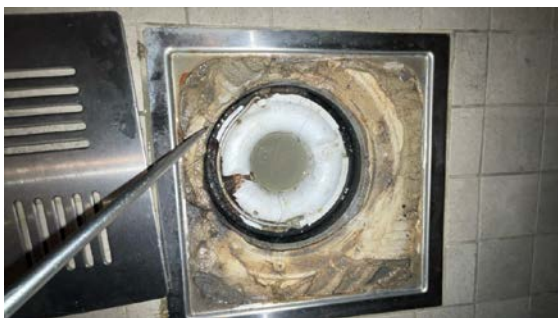
Plastsluk i gulv.
