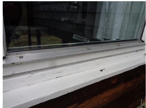
Noe værslitt utvendig.
