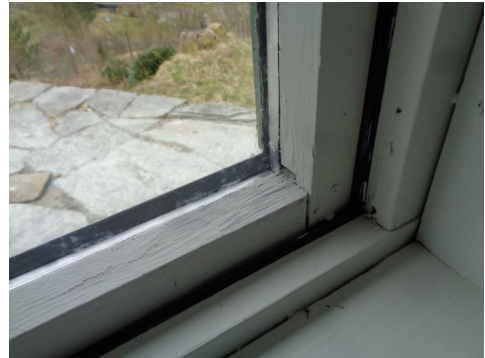
Noe slitt og oppsprekk i trekarmen og vinduer.
