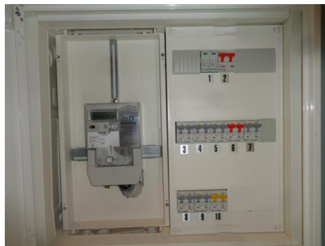
Sikringsskap i entrè.
