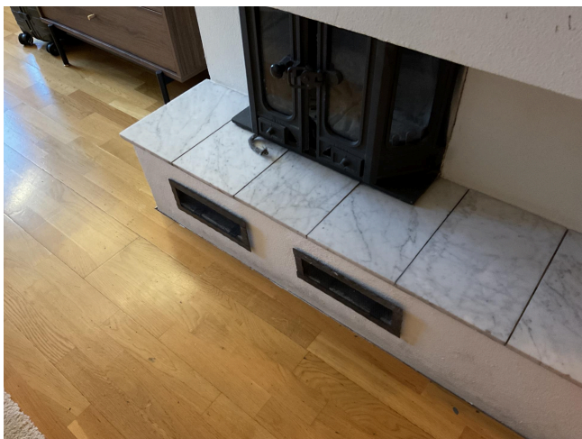
Manglende gnistplate på gulv.
