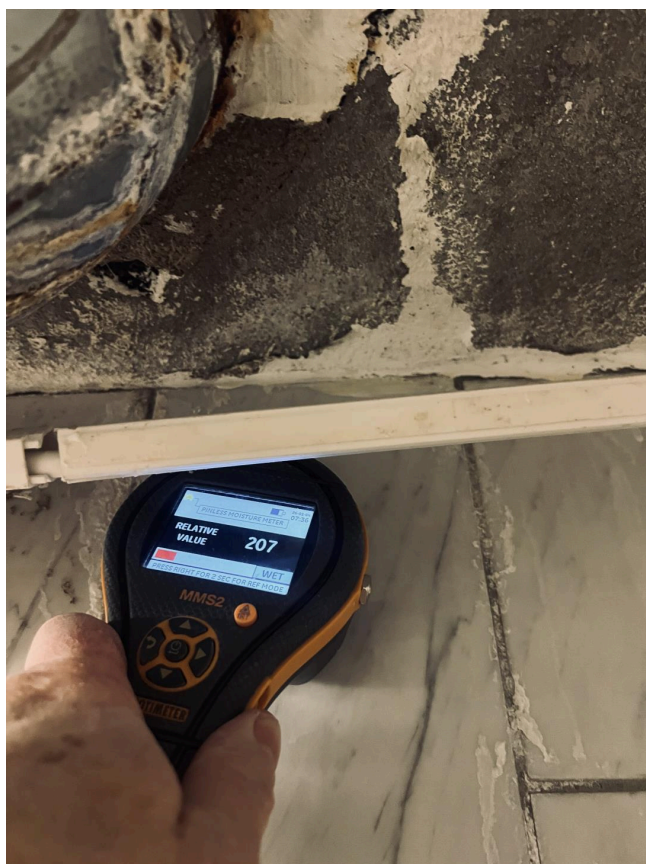
Registrert fukt i vegg ved tak i vaskerom.
