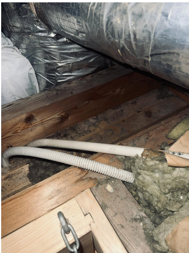
Trekkerør for el-ledninger på loft.
