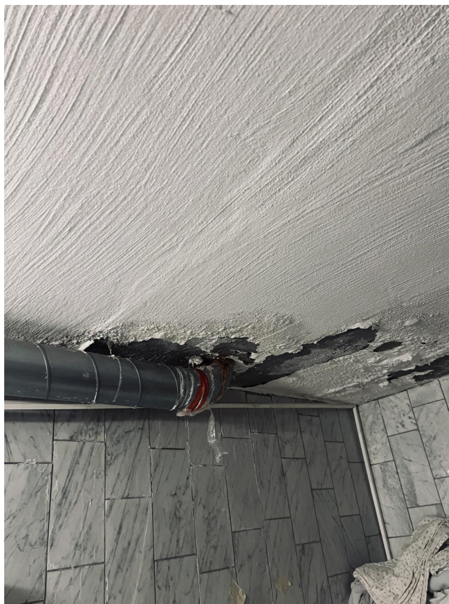
Avflassing og fuktmerker i tak i vaskerom.
