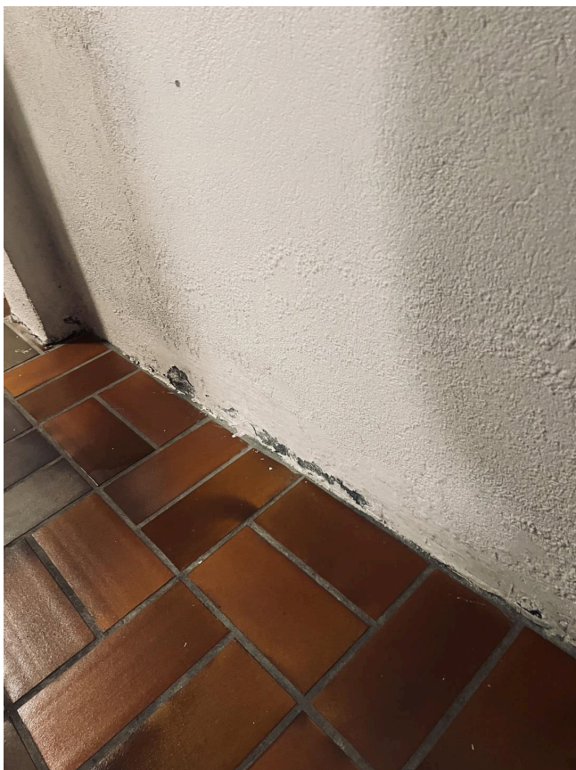
Fuktmerker på innvendig bærevegg.
