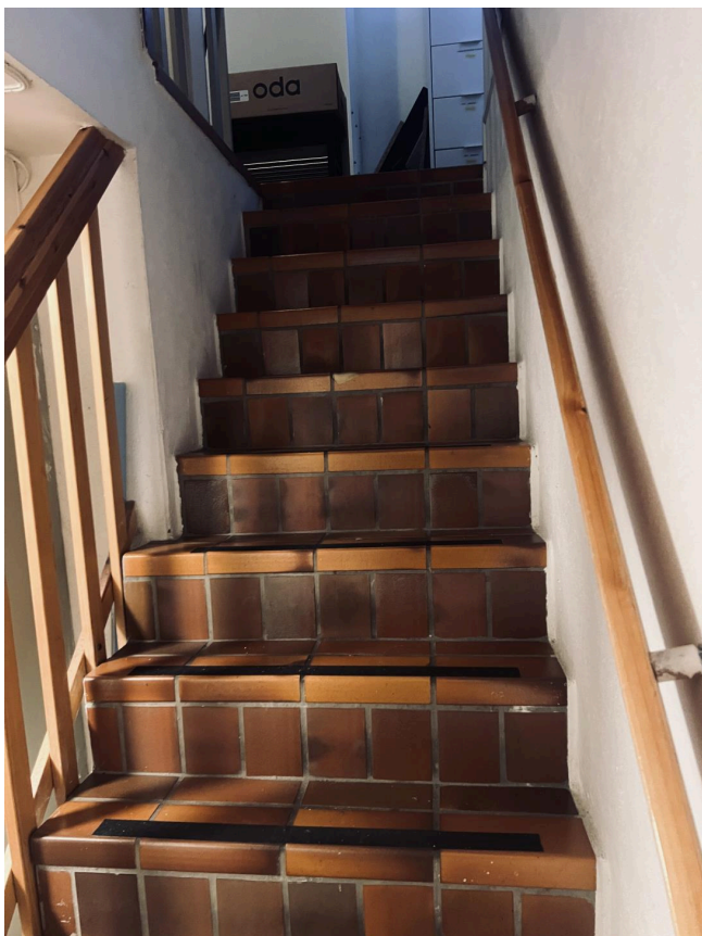
Manglende håndløper i øvre del av trapp. Løs håndløper.
