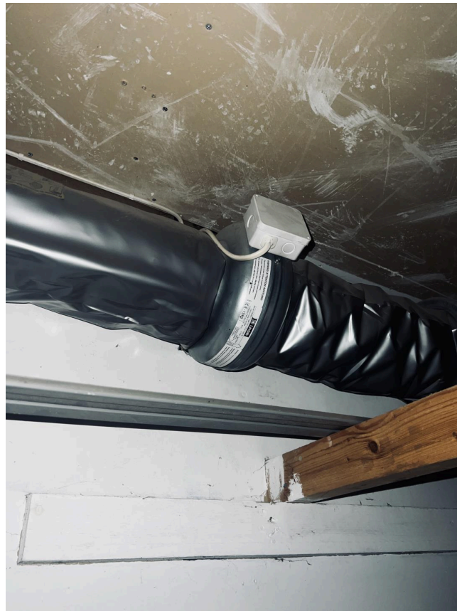
Avtrekk plassert i garasje.
