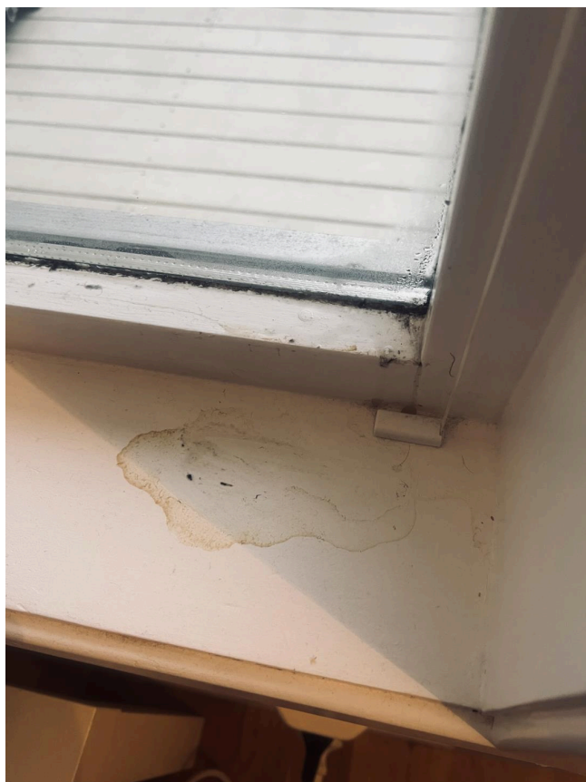
Kondensering på vinduer i 2. etg. fra dårlig ventilasjon/høy luftfuktighet.
