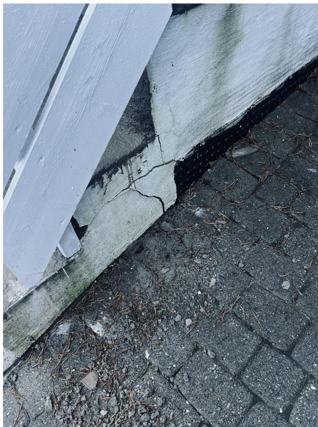
Skader på begge sider av trapp.
