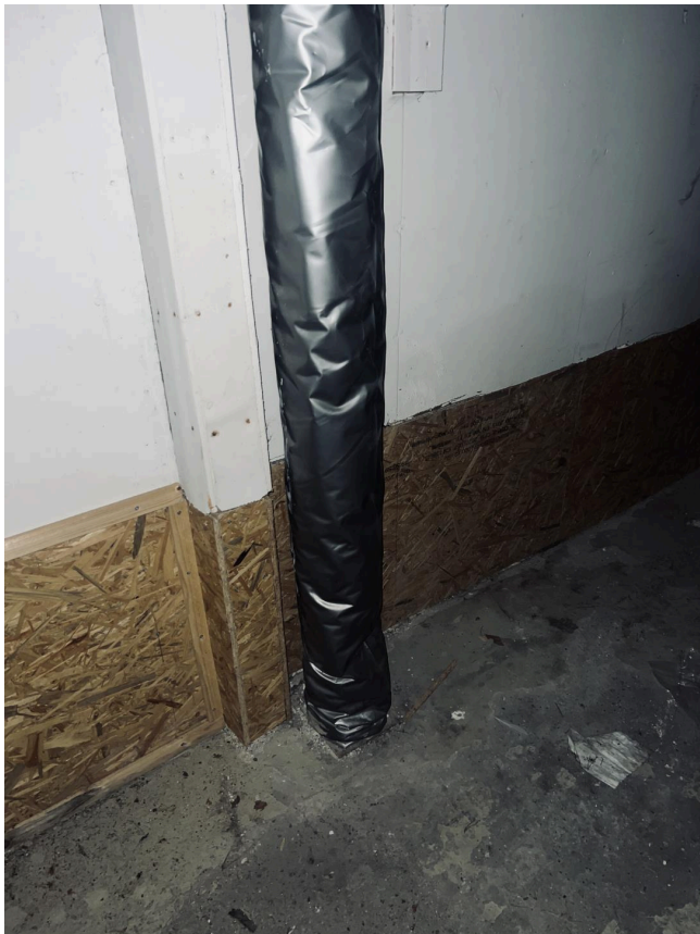
Treplater på vegg av ukjent årsak.
