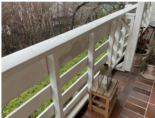
Rekkverk med mulighet for klatring.
