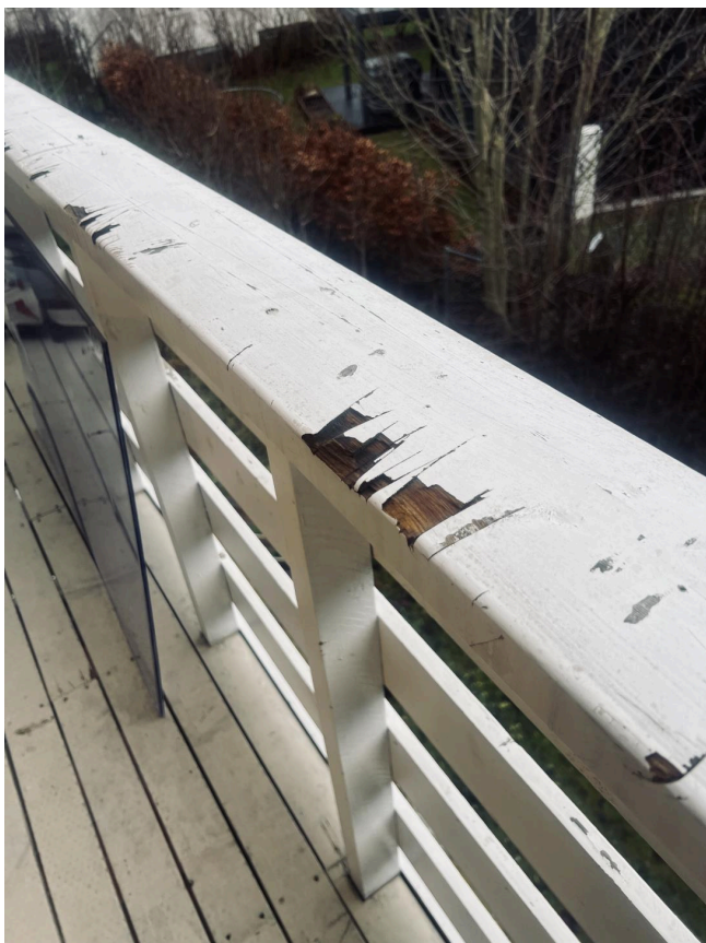
Skade på rekkverk i 2. etg.
