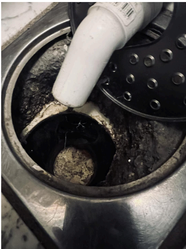
Sluk i vaskerom.
