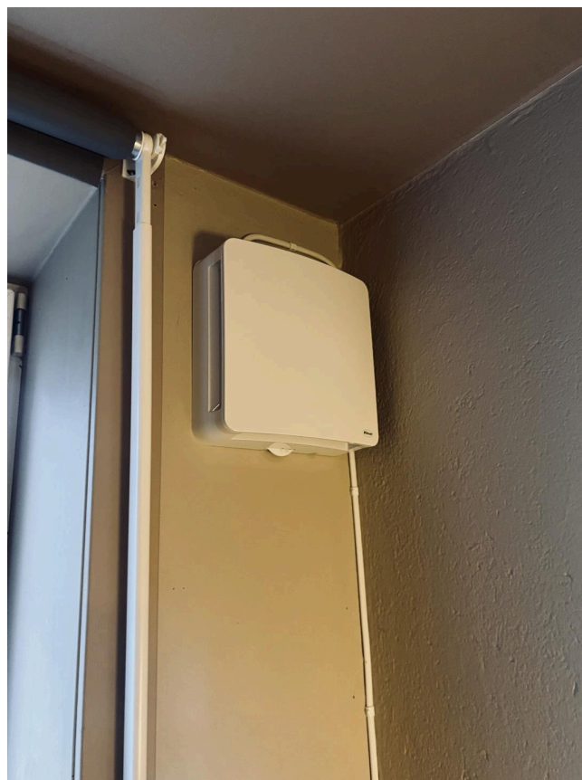
Ventilasjonsenheter montert i 2 av kjellerrommene.
