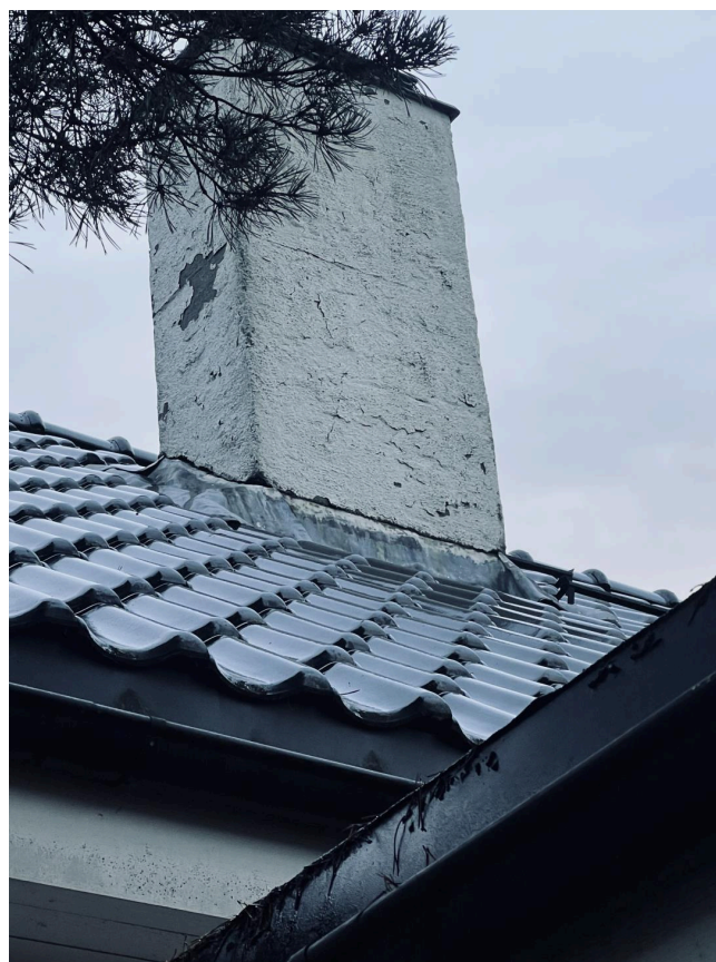
Avflassing på utvendig pipe.
