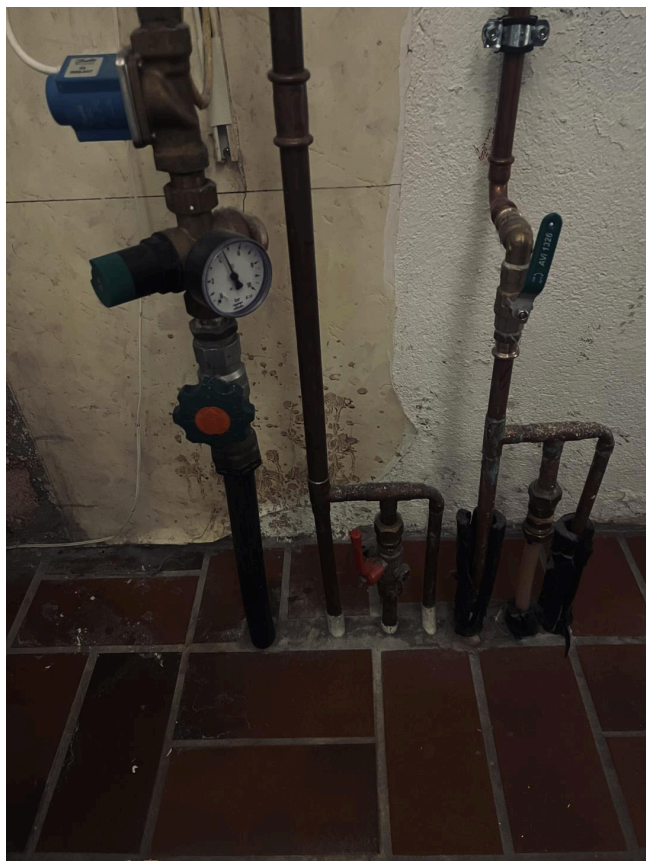
Stoppekran i kjeller. eldre kobber-rør.
