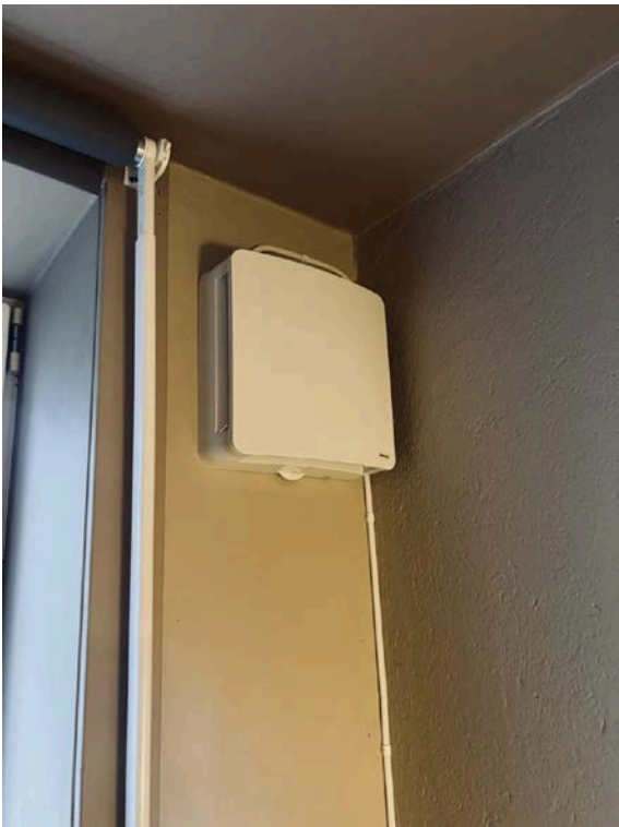
Ventilasjonsenheter montert i 2 av kjellerrommene.
