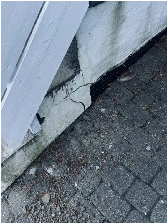
Skader på begge sider av trapp.
