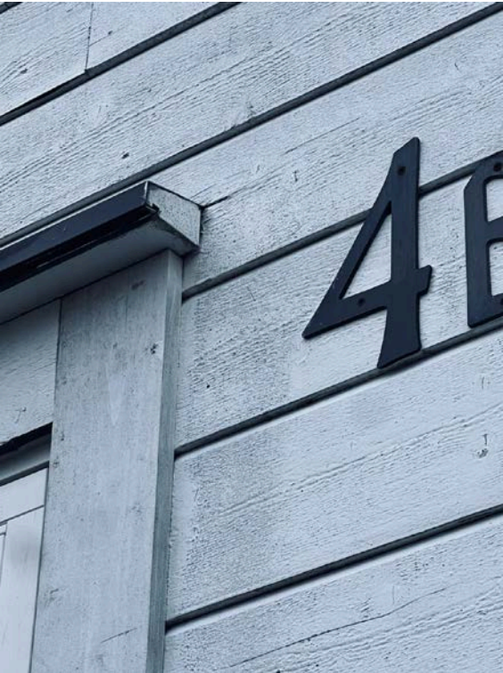
Det tyder på at det kan være en skade på kledning over vinduet.
