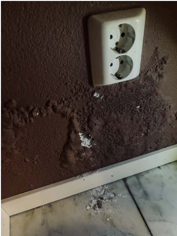
Blæring på vegg i kjeller-rom. Ingen unormale fuktverdier registrert.
