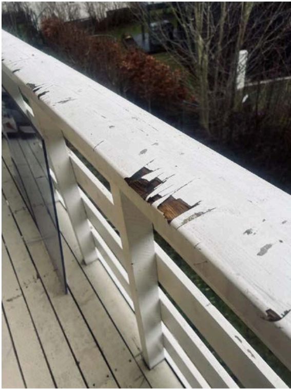
Skade på rekkverk i 2. etg.
