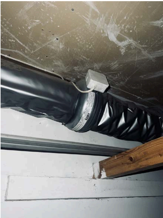
Avtrekk plassert i garasje.
