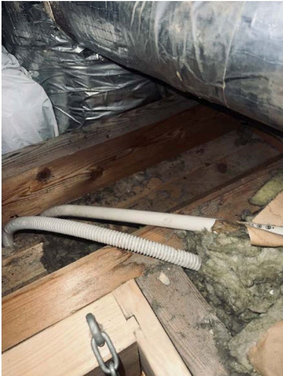
Trekkerør for el-ledninger på loft.
