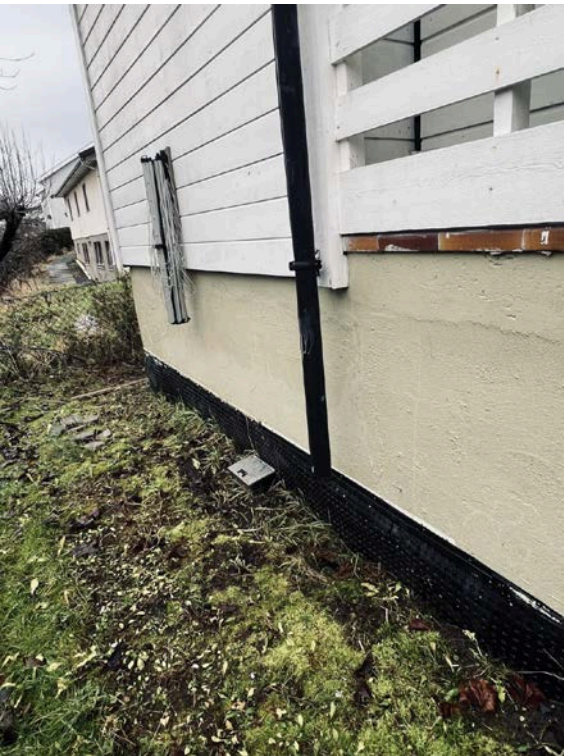
Vann fra taknedløp blir ikke ledet bort fra bygget. Terreng har ikke fall bort fra bygget.
