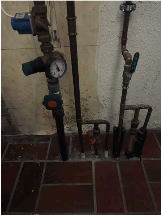
Stoppekran i kjeller. eldre kobber-rør.
