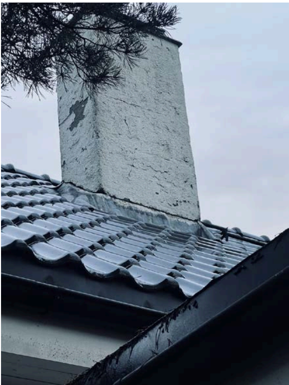
Avflassing på utvendig pipe.
