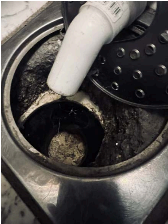
Sluk i vaskerom.
