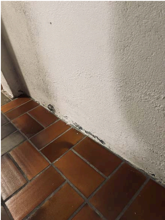
Fuktmerker på innvendig bærevegg.
