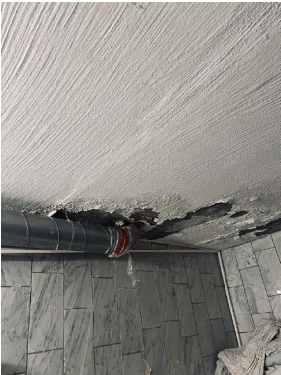
Avflassing og fuktmerker i tak i vaskerom.
