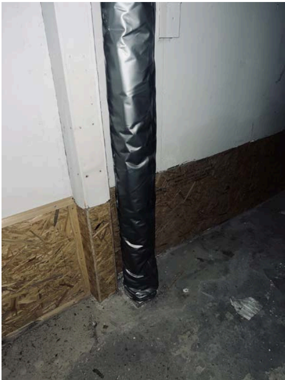
Treplater på vegg av ukjent årsak.
