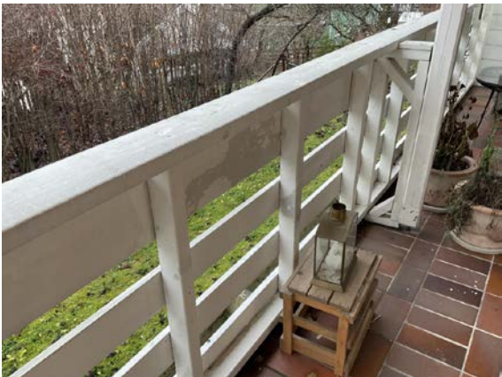
Rekkverk med mulighet for klatring.
