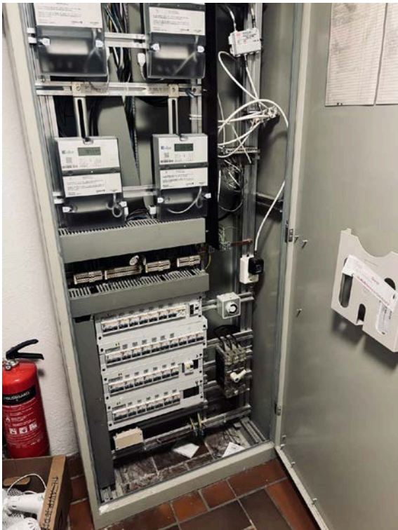
Sikringskap plassert i gang i kjeller.
