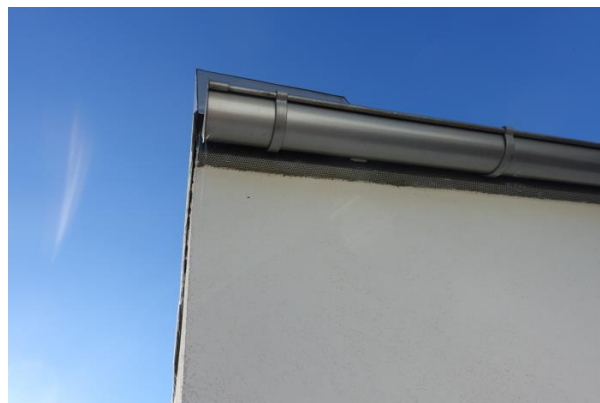
Synlig luftespalte ved raft.
