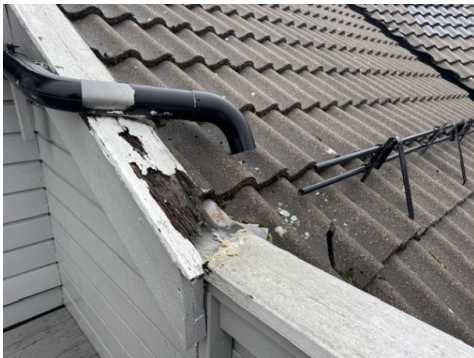
råte på rekkverk/lister/israft
