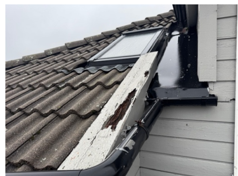
råte på rekkverk/lister/israft
