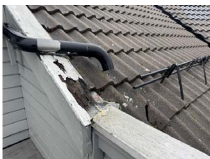
råte på rekkverk/lister/israft
