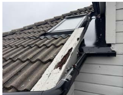
råte på rekkverk/lister/israft
