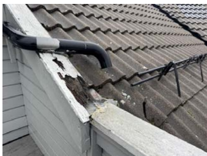
råte på rekkverk/lister/israft
