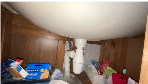
Del av rør til avløp.
