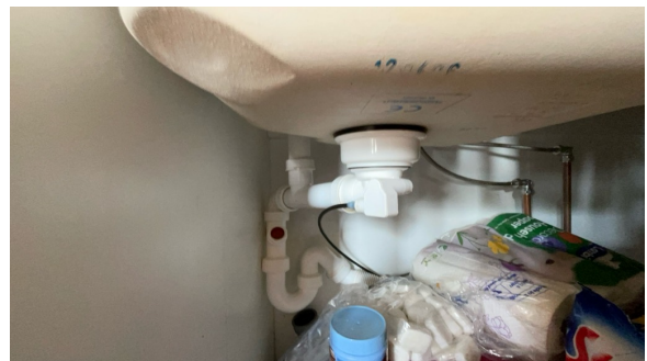
Del av rør til avløp.
