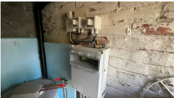
Styreskap til avløpspumpe.
