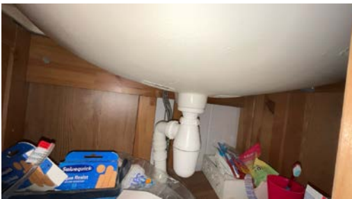
Del av rør til avløp.
