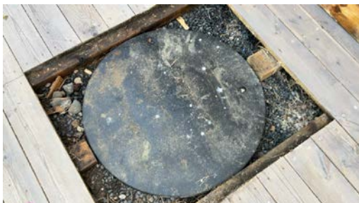
Tank med kværnepumpe.
