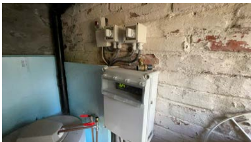
Styreskap til avløpspumpe.
