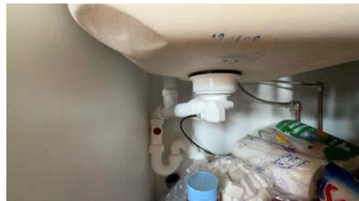
Del av rør til avløp.
