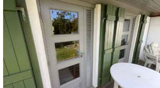
Eksempel på montert ventil i dør felt.
