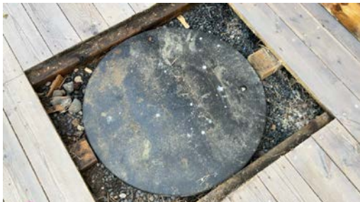
Tank med kværnepumpe.
