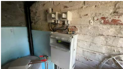
Styreskap til avløpspumpe.
