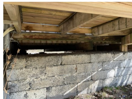
Skjevhet i støttemur under terrasse.
