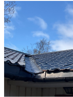
Stedvis rust og flassende belegg på takplater
