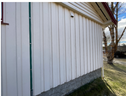
Sprekk slitasje i solvegger
