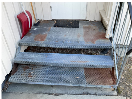
Rust og nedbøy i trinn.
