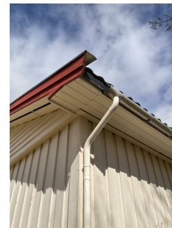
Mangler del av takrenne samt nedløp
