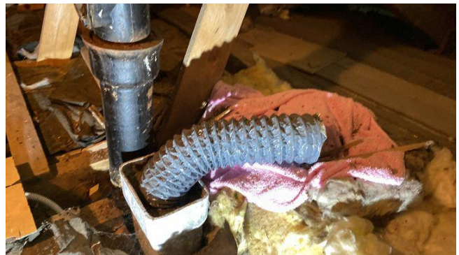
Lufting fra antatt bad kommer ut på loft og er ikke ført over tak.
