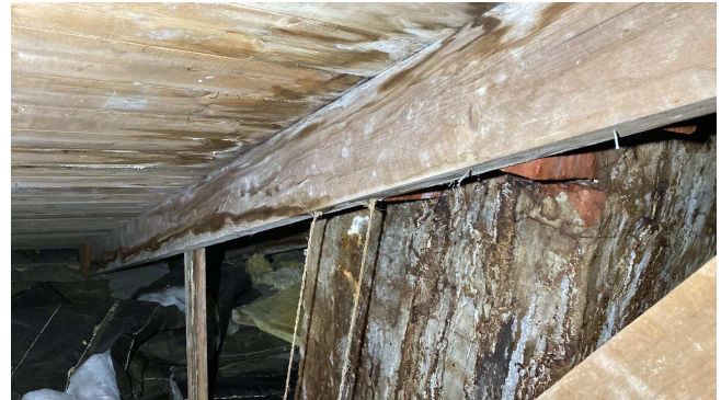
Tegn til at det tidvis kommer inn vann ved pipe. Rennmerker på taksperre og pipe.
