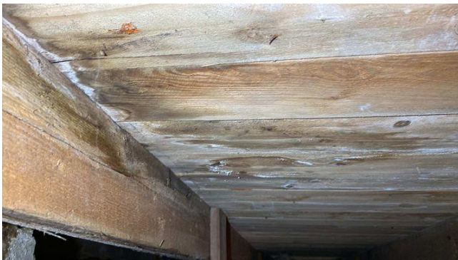
Tegn til at det tidvis kommer inn vann ved pipe. Rennmerker på taksperre og mugg på rupanel.
