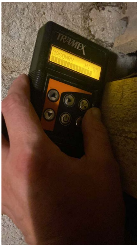
Fullt utslag på indikasjon måling på nedre del av murvegg mot kjellergulv i vedbod.
