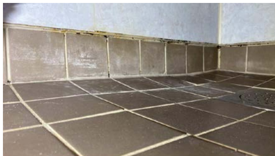
Mugg på fuger i dusj. Ufagmessig utførelse på baderomsplater/fliser.
