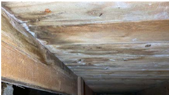
Tegn til at det tidvis kommer inn vann ved pipe. Rennmerker på takspærre og mugg på rupanel.
