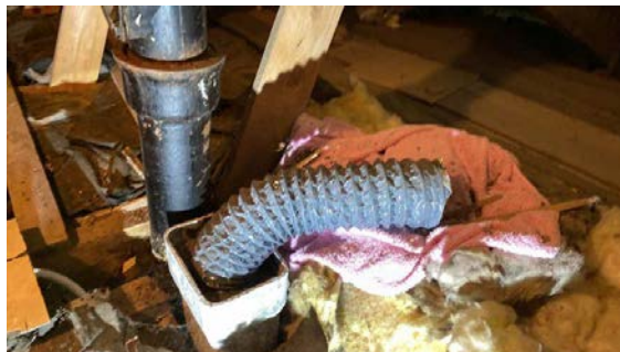
Lufting fra antatt bad kommer ut på loft og er ikke ført over tak.
