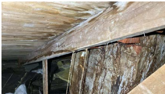
Tegn til at det tidvis kommer inn vann ved pipe. Rennmerker på takspærre og pipe.
