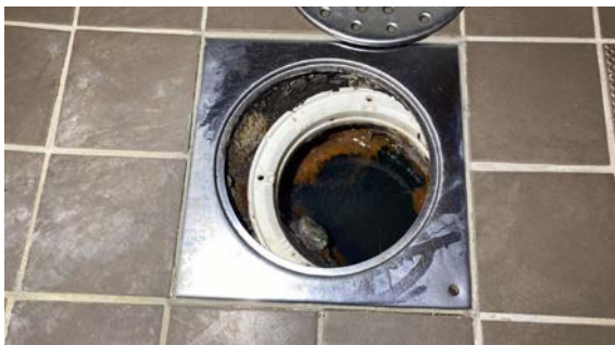
Ingen membran ved sluk. Sluk er ikke midtstilt på slukrist.
