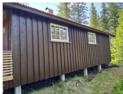
Kontroll av musesperre.
