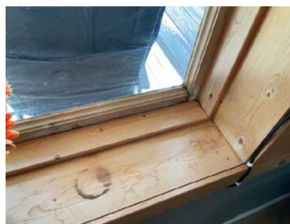
Innvendig duggmerker i karm og utforing.
