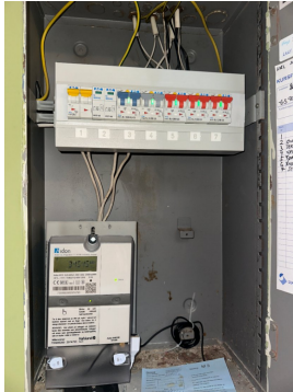
Sikringskap med automatsikringer.
