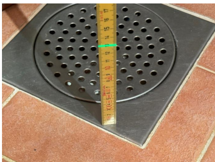
Fallforhold ca. 130 mm topp slukrist i dusjsone
