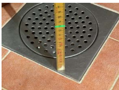
Fallforhold ca. 130 mm topp slukrist i dusjsone
