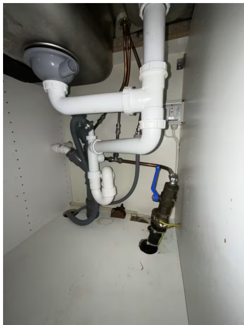
Viser vann og avløpsinnstallasjoner under kum.
