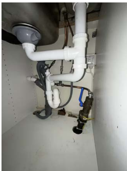
Viser vann og avløpsinnstallasjoner under kum.
