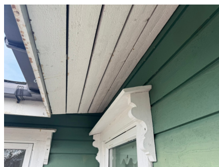
Eksempel på tegn til lekkasje.
