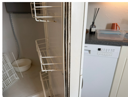
Skader på pakning, svertesopp på pakning.
