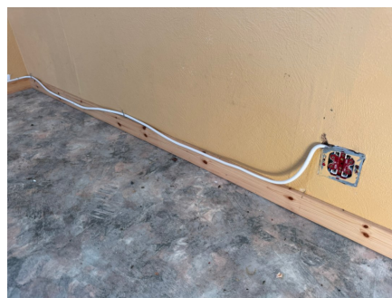
Løs ledning og stikkontakt uten deksel.
