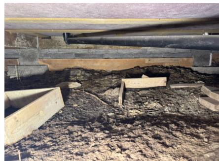
Innerste delen av krypekjelleren er fuktig på bakken.
