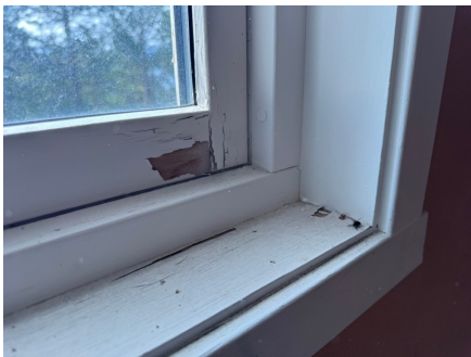
Eksempel på fuktskade på innsiden av vindu.
