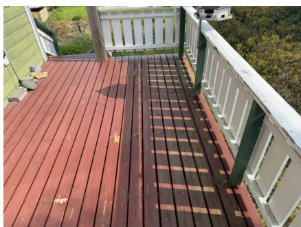
Eksempel på værslitt og oppsprukket trevirke.
