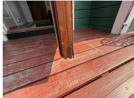
Skade på ytterdøren.
