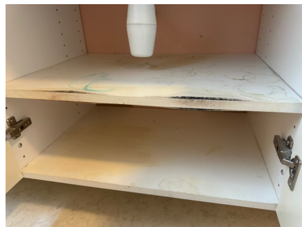
Fuktskader på innredningen.
