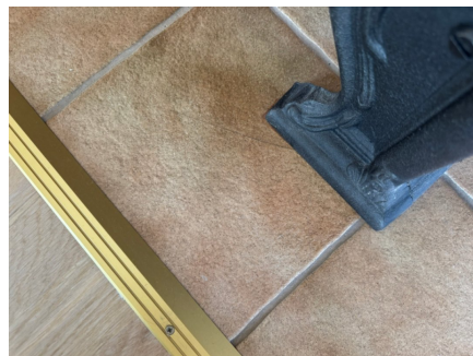
Sprukket flis under vedovnen.
