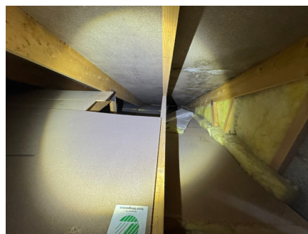
Fuktskader på taktroplater.
