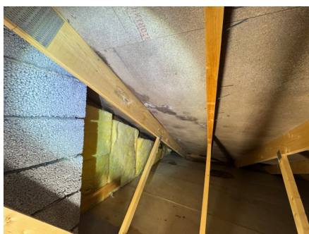
Fuktskader på taktroplater.
