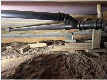
Avløpsrør i krypkjeller er ikke frostsikret.
