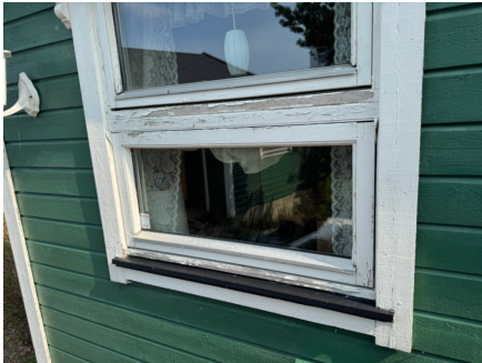
Eksempel på værslitt vindu.
