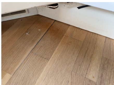
Fuktskader på gulvet.
