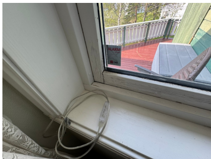
Tegn til innvendig kondensering.
