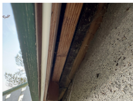
Det er ikke montert musesperre.
