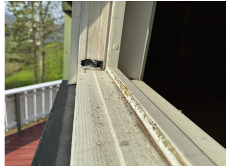
Eksempel på skade på pakning.
