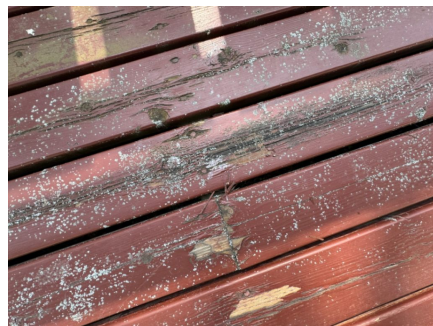
Eksempel på værslitt og oppsprukket trevirke.
