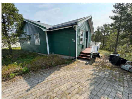
Det er fall på terrenget mot grunnmuren.
