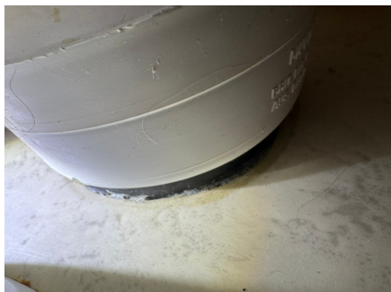
Eksempel på utettheter rundt rørgjennomføring.
