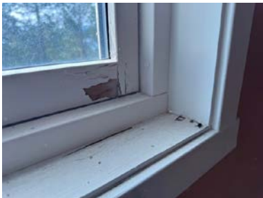
Eksempel på fuktskade på innsiden av vindu.
