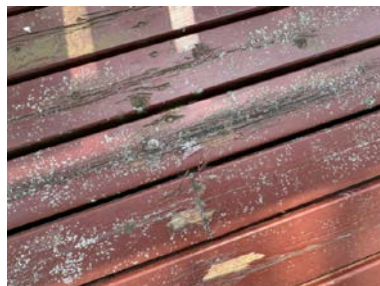
Eksempel på værslitt og oppsprukket trevirke.
