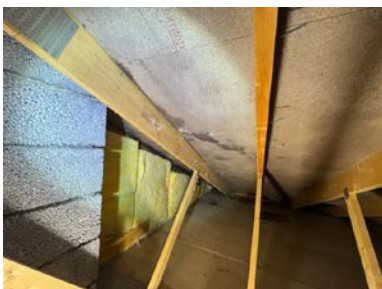
Fuktskader på taktroplater.
