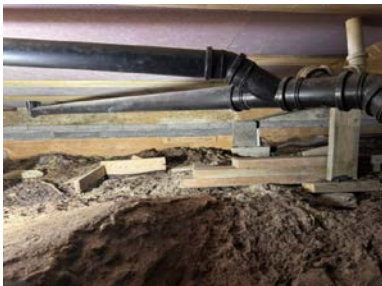
Avløpsrør i krypkjeller er ikke frostsikret.
