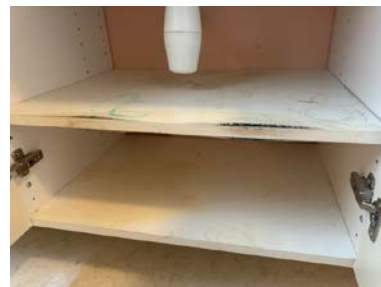
Fuktskader på innredningen.
