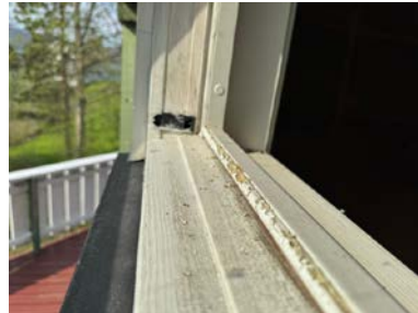
Eksempel på skade på pakning.
