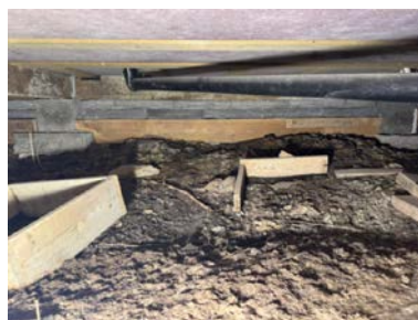
Innerste delen av krypekjelleren er fuktig på bakken.
