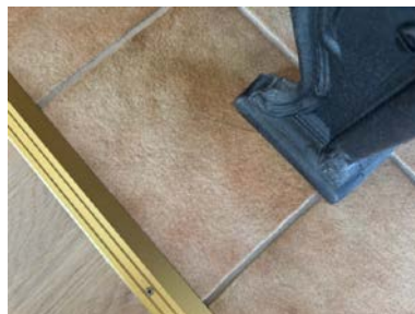
Sprukket flis under vedovnen.
