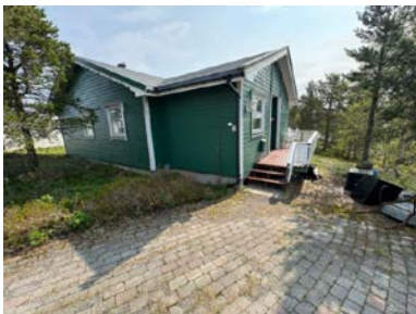
Det er fall på terrenget mot grunnmuren.
