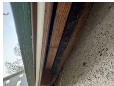
Det er ikke montert musesperre.
