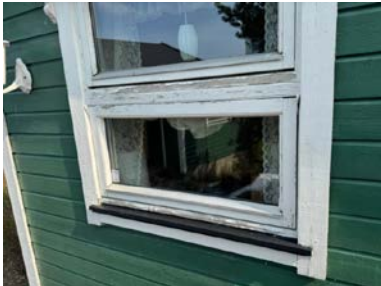
Eksempel på værslitt vindu.
