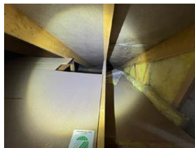
Fuktskader på taktroplater.
