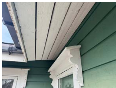
Eksempel på tegn til lekkasje.
