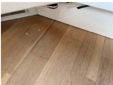
Fuktskader på gulvet.
