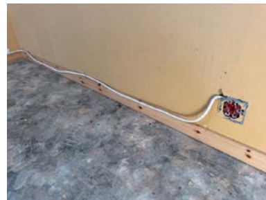
Løs ledning og stikkontakt uten deksel.
