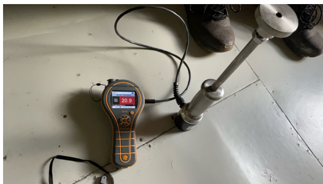
Svill viser fuktighet der det er skjevheter.
