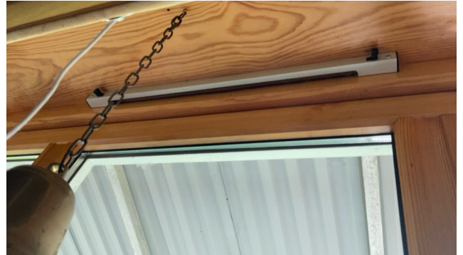
Ventiler i vindu.
