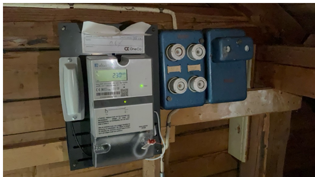
Sikringer montert på loft.
