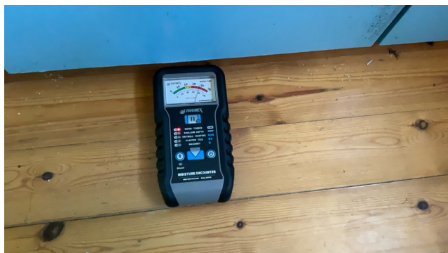
Fuktindikator gir utslag på fukt på kjøkkengulv. (krypkjeller under).
