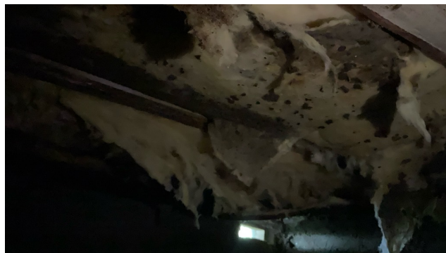
Stubbeloftplater har falt ned grunnet råte.
