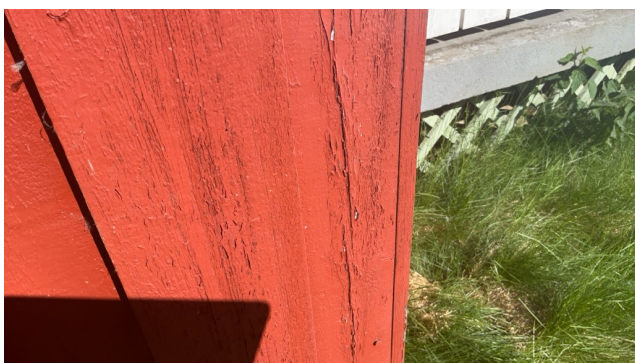
Eksempel på sprukkede kledningsbord.
