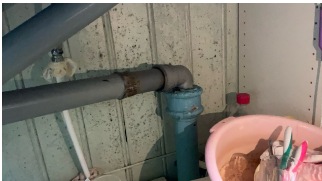
Eksempel på soppdannelser under kjøkkenbenk.
