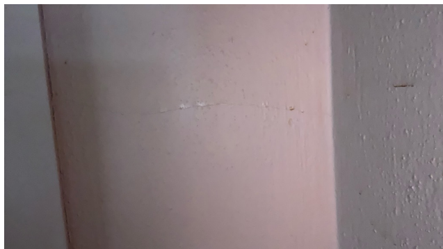
Riss/sprekk i pipe.
