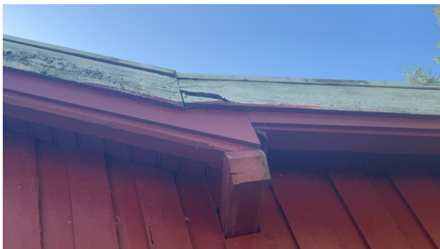
Eksempel på råteskade i vindski.
