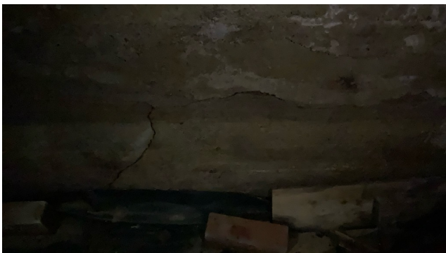
Sprekker i betonggrunnmur i krypkjeller.
