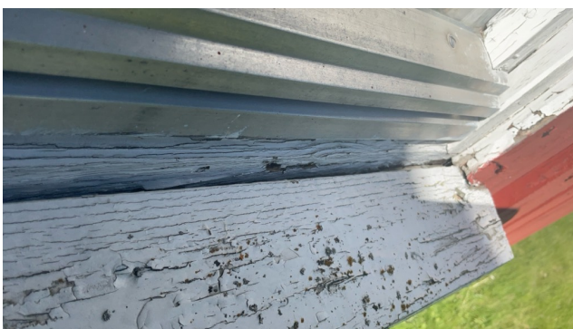
Vannbrett uten beslag har trekt seg ut fra vegg.
