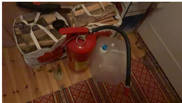
Brannslukningsapparat eldre enn 10 år.
