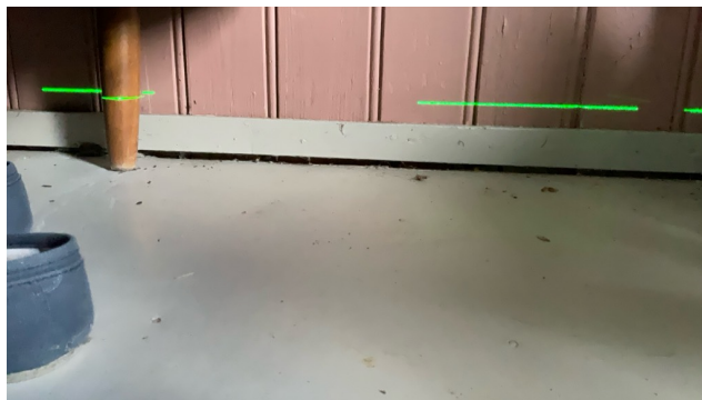
Stor glippe mellom gulv og gulvlist.
