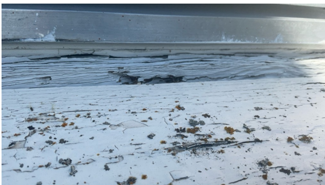
Eksempel på råte i enkelte vinduer.
