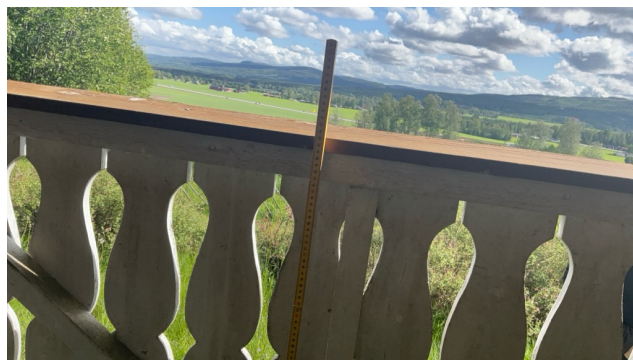
Rekkverk målt til ca 90cm.
