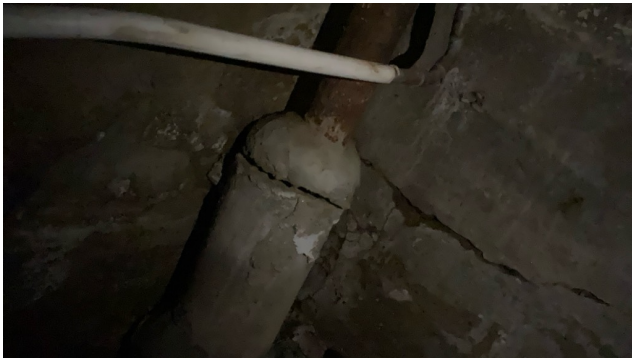
Skade i avløp i krypkjeller.
