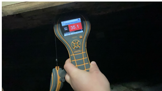
Det er påvist fukt med målinger i treverk med pigger.
