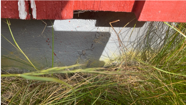
Eksempel på sprekkdannelser i grunnmur.
