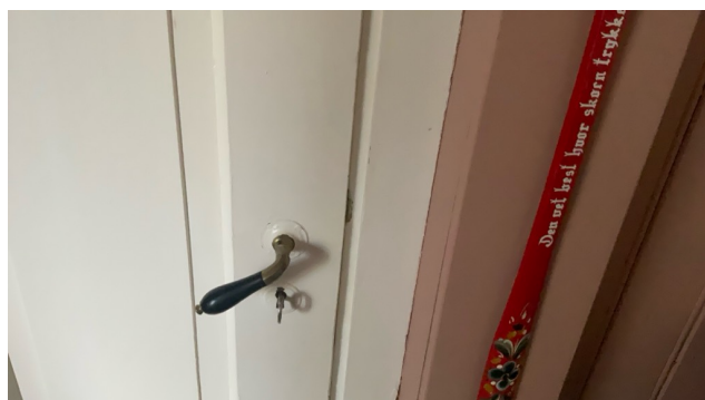
Innerdør tar i karm ved åpning/lukking.
