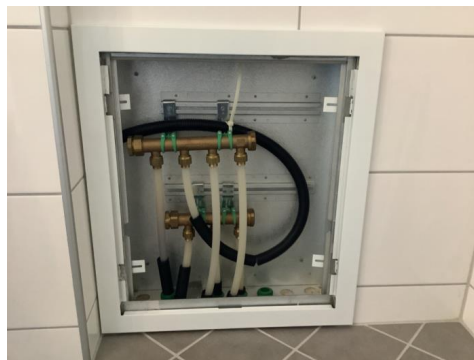
Mot yttervegg i bad i loftet etasje. Det er ikke observert forskriftsmessig dren fra skapet til avløp.
