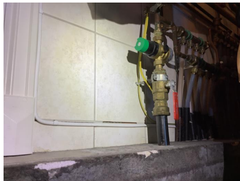
Vanninntak og stoppekran i vaskerom i første etasje.
