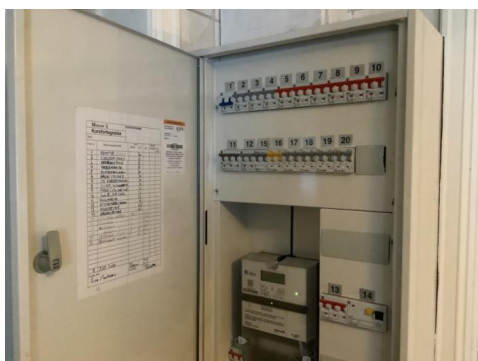
Sikringsskap i vaskerom/teknisk rom.
