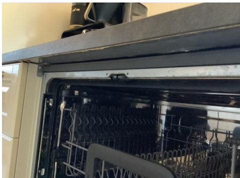
Fuktsvell i benkeplate nær oppvaskmaskin
