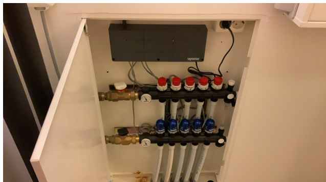
Fordelerskap med rørkurser med fordelerstamme og fjernstyring for termostater
