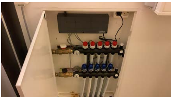
Fordelerskap med rørkurser med fordelerstamme og fjernstyring for termostater
