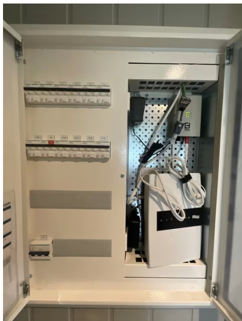
Viser sikringsskap plassert i gang.
