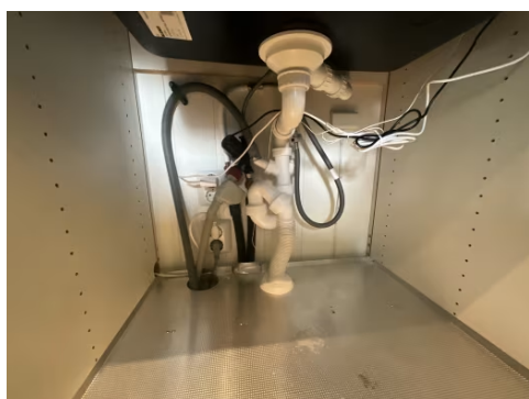
Viser vann og avløpsinnstallasjoner under kum.
