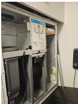
Bilde av inne i ventilasjonsaggregat
