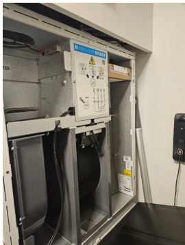
Bilde av inne i ventilasjonsaggregat
