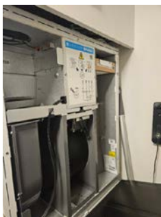
Bilde av inne i ventilasjonsaggregat
