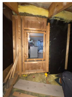
Manglende isolasjon rundt kottdør.
