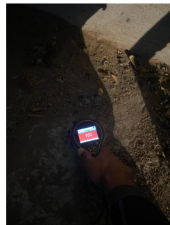
Det er påvist indikasjoner på noe fuktgjennomtrenging i kjellergulv.
