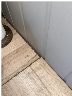
Ufagmessig utførelse av benkeplate.
