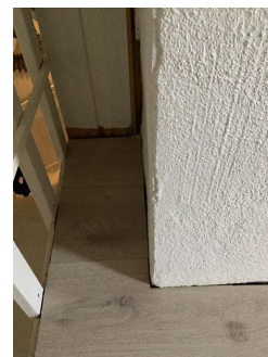
Eksempel på manglende gulvlist.
