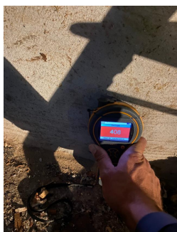
Det er påvist indikasjoner på noe fuktgjennomtrenging inn i kjellermur.
