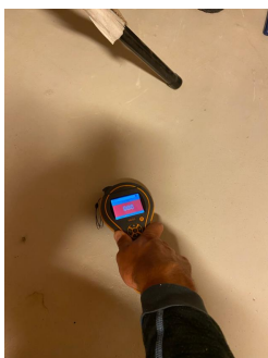
Fuktsøk med forhøyede verdier.
