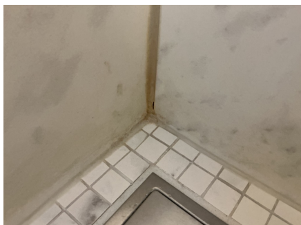
Det registreres elastiske fuger med manglende vedheft i dusjsjonen.
