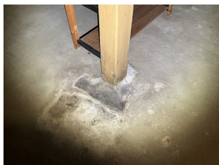
Pågebegynnende råteskader i plassbygd reol.
