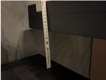
Åpninger mellom trinn overstiger 10cm.
