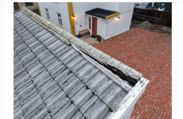
Råteskader i takkonstruksjon.
