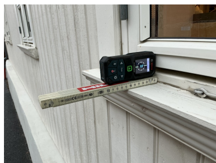
Vannbrett har ikke fall fra vinduer.
