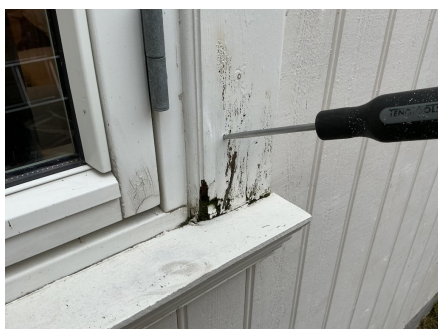
Det er råteskader i omrammingsbord.
