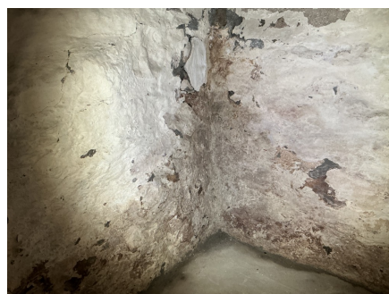
Tegn til fuktvandring på grunnmuren.
