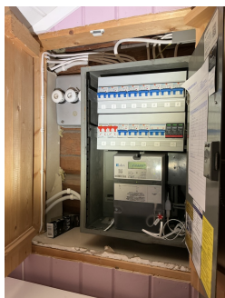
Sikringsskap er plassert i loftsetasje.
