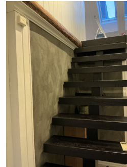
Det er ikke etablert håndløper på vegge
