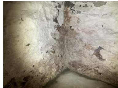
Tegn til fuktvandring på grunnmuren.
