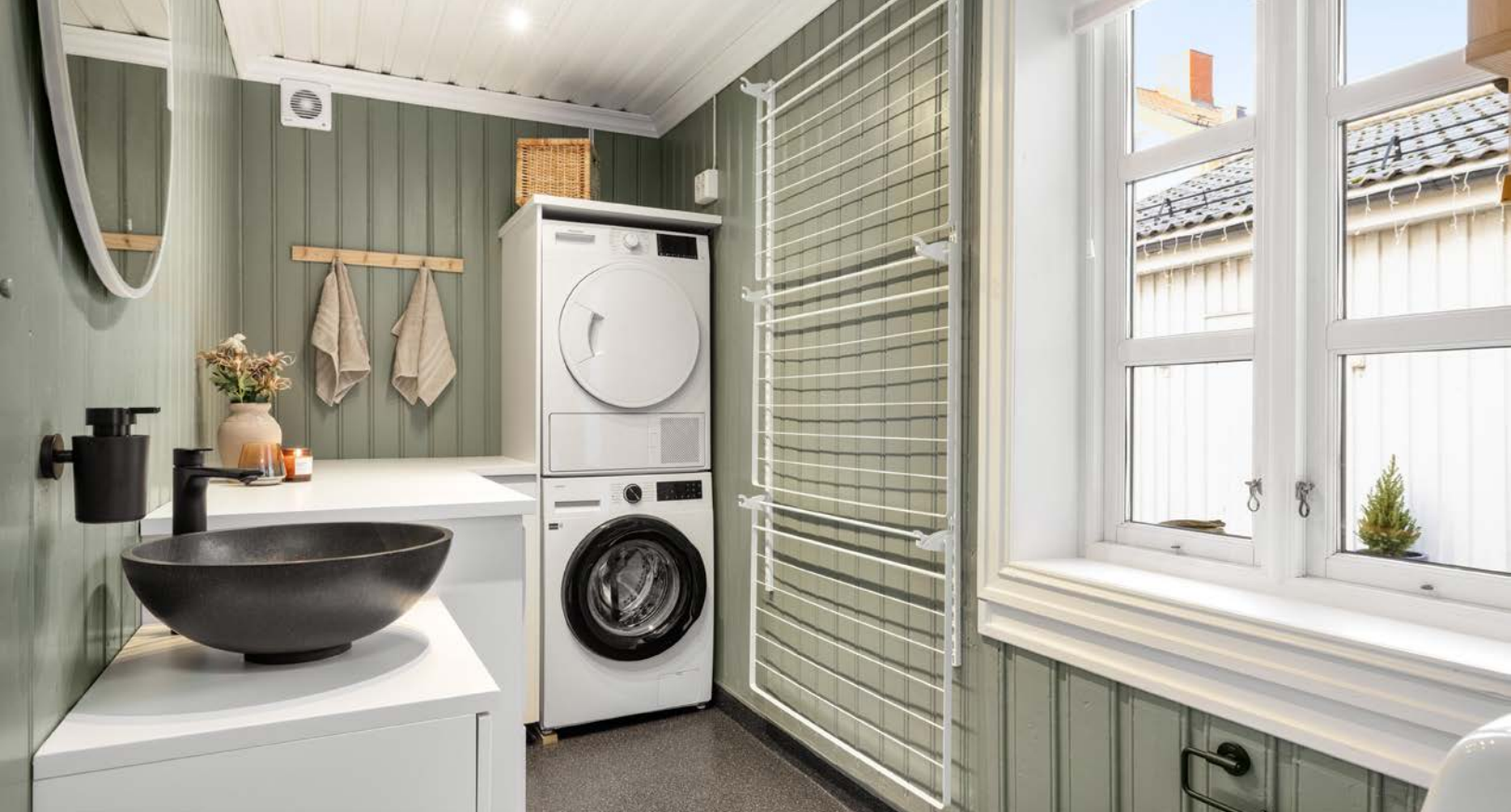
I 1. etasje er det et praktisk vaskerom kombinert med toalettrom. Rommet er utstyrt med opplegg for vaskemaskin og tørketrommel i søyle og har også øvrig innredning.
