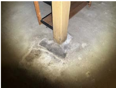
Pågebegynnende råteskader i plassbygd reol.
