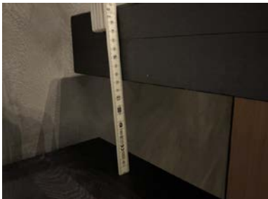
Åpninger mellom trinn overstiger 10cm.
