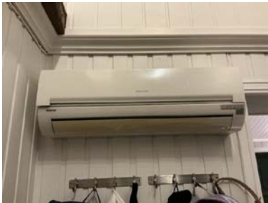
Varmepumpe er plassert i gang.
