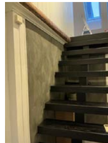
Det er ikke etablert håndløper på vegge
