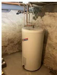
Varmtvannsbereder er plassert i uinnredet kjeller.
