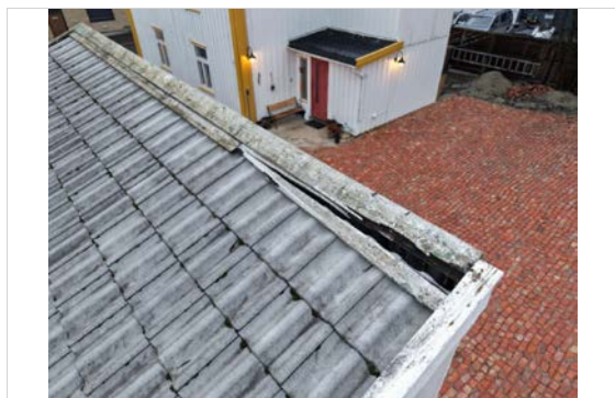
Råteskader i takkonstruksjon.
