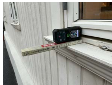
Vannbrett har ikke fall fra vinduer.
