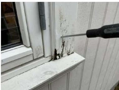
Det er råteskader i omrammingsbord.
