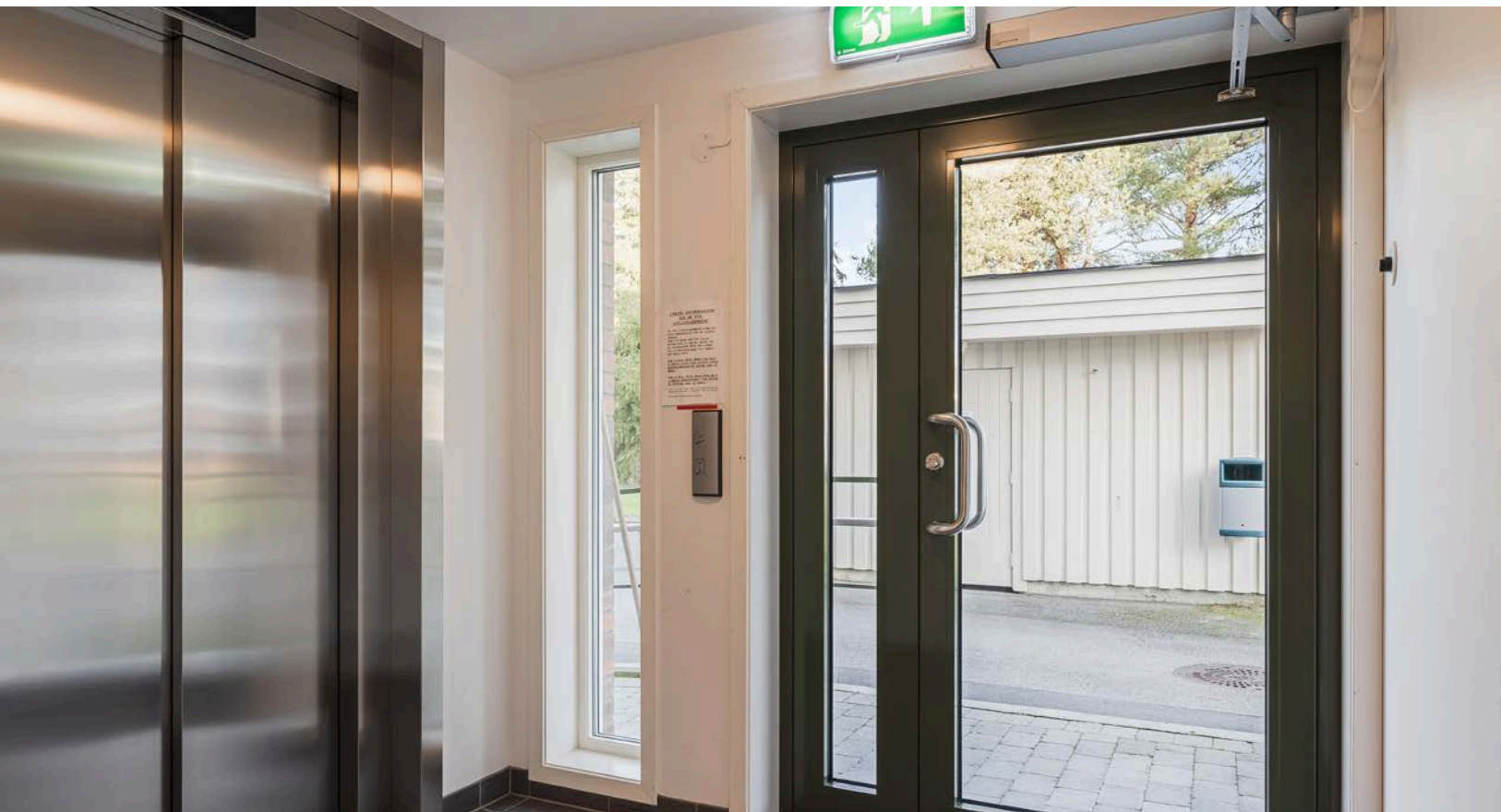
Blokken har nyere heis fra 2021-2022.
