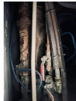
Rør-opplegg/stoppekraner inne i vegg bak luke i bad.
