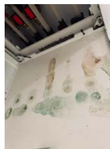
Merker inne i fordelerskap, med merker etter tidligere lekkasjer.
