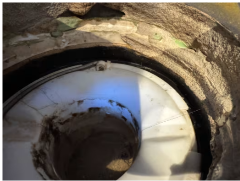
Synlig tettesjikt i sluket.
