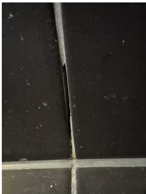
Avvik på flisfuger på veggen.
