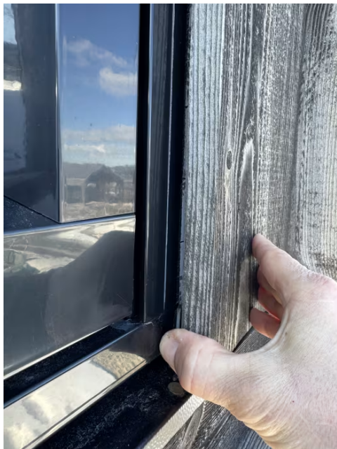
Det er åpninger mellom panel og vinduer.
