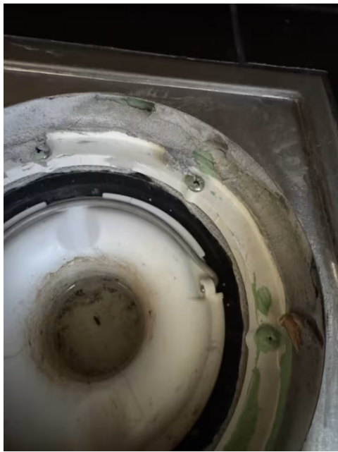
Synlig tettesjikt i sluket.
