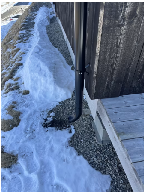
Takvann er ledet vekk fra grunnmur via utkast montert på nedløp.
