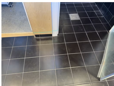
Svært begrenset fallforhold.
