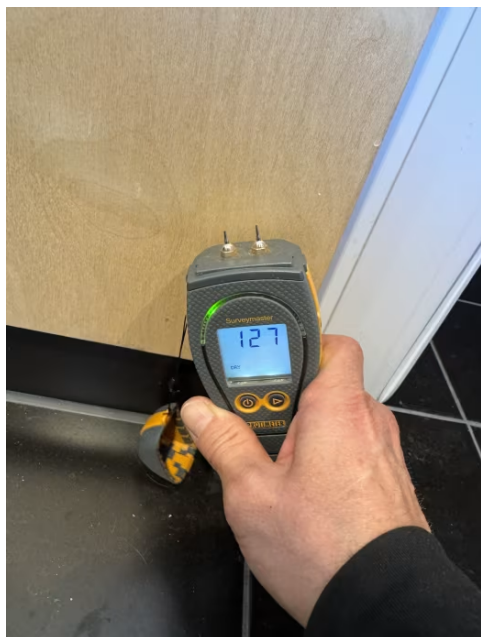
Dør og uegnede materialer i våtsone, men ingen påviste fuktskader.
