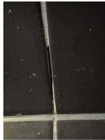
Avvik på flisfuger på veggen.
