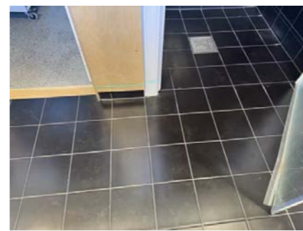
Svært begrenset fallforhold.
