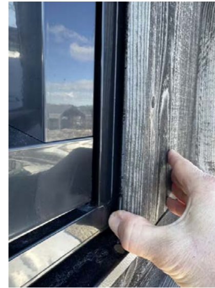
Det er åpninger mellom panel og vinduer.
