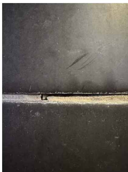
Avvik på flisfuger på veggen.
