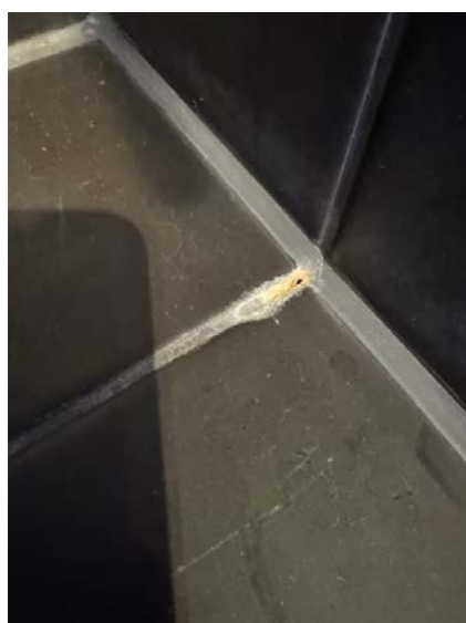
Svært begrenset fallforhold.
