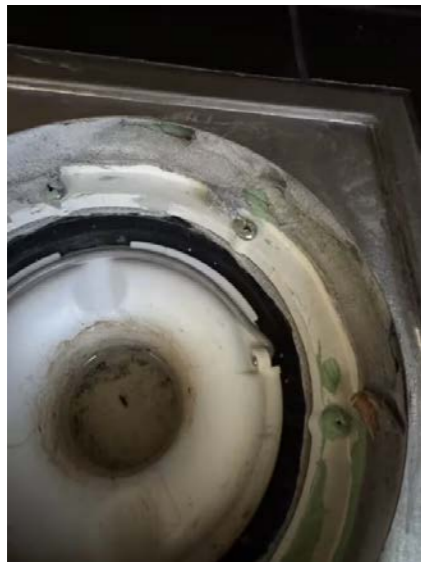
Synlig tettesjikt i sluket.
