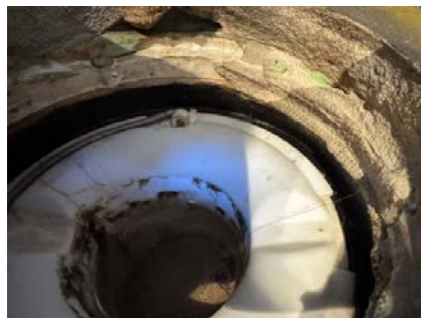
Synlig tettesjikt i sluket.
