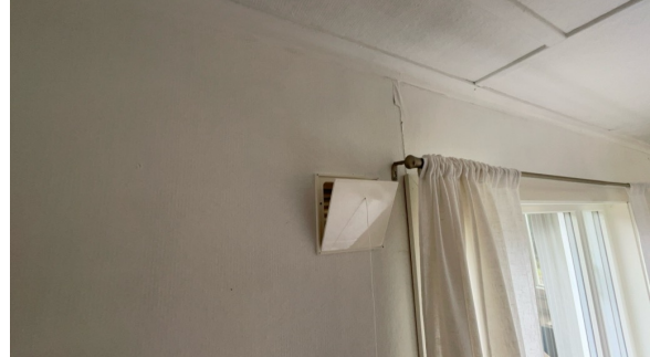
Eksempel på montert ventil i vegg.
