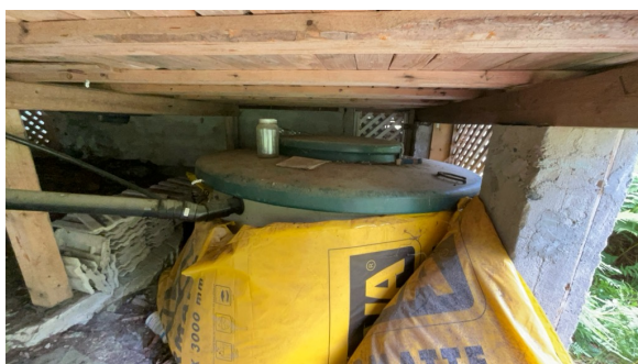
Tank for gråvann.
