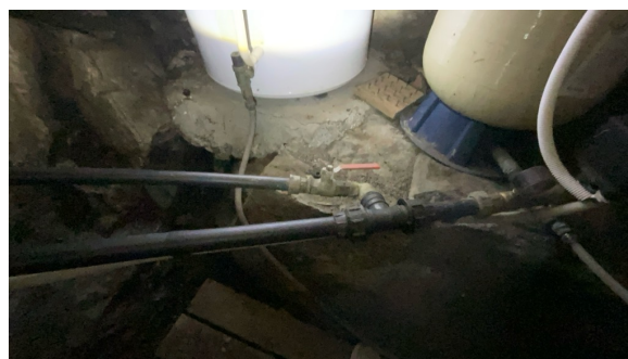
Del av rør til vann.
