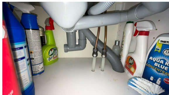
Del av rør til vann.
