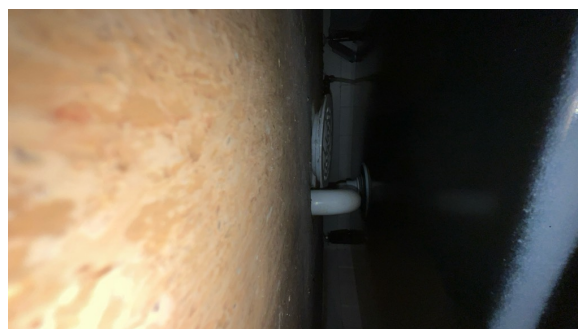
Sluk i gulv under dusjkabinett.
