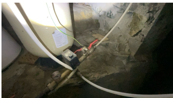
Del av rør til vann. Stoppekran til vann.
