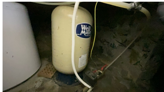
Trykktank til borehull.
