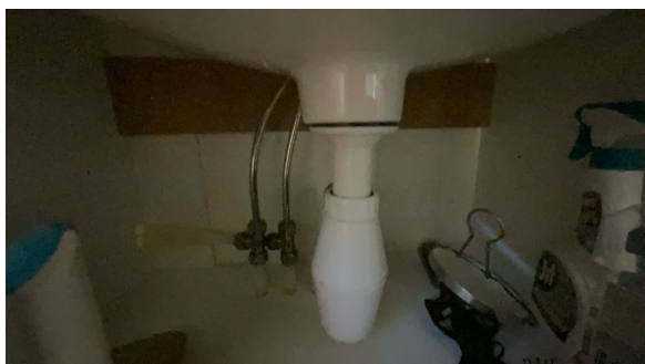
Del av rør til avløp.
