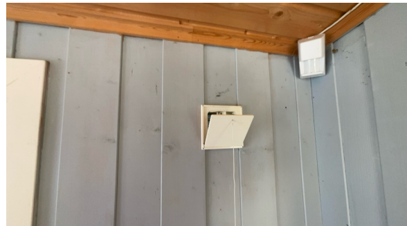
Eksempel på montert ventil i vegg.
