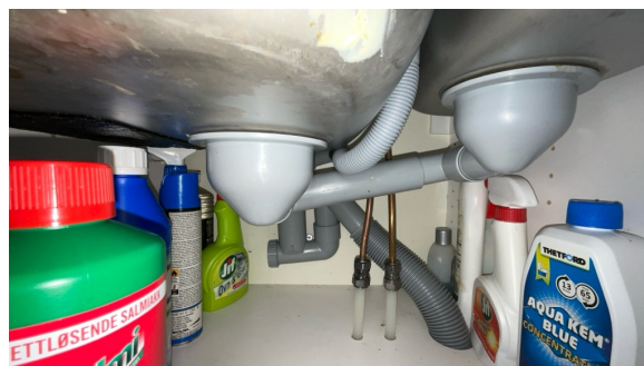
Del av rør til avløp.
