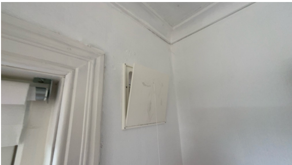
Eksempel på montert ventil i vegg.
