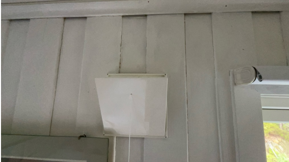
Eksempel på montert ventil i vegg.
