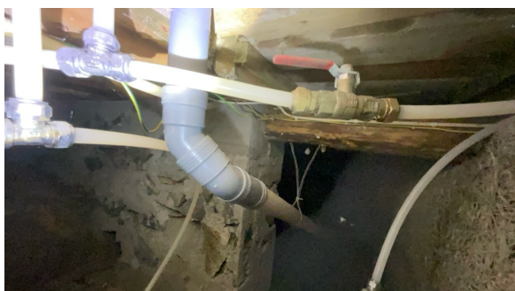
Del av rør til avløp.
