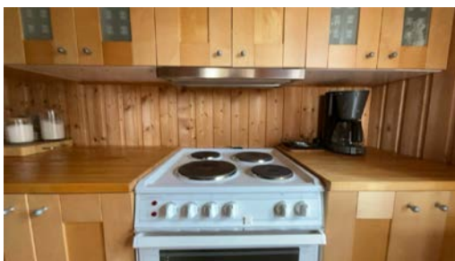
Montert avtrekk over komfyr.
