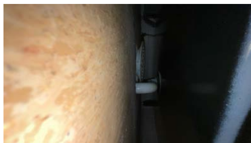
Sluk i gulv under dusjkabinett.
