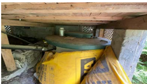
Tank for gråvann.
