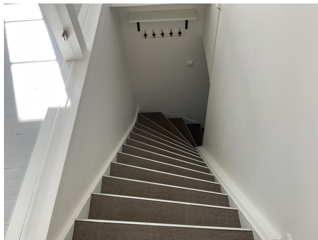
Manglende håndløper på vegger.
