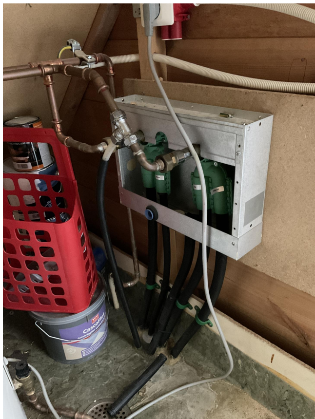
Fordelerskap plassert på loft.
