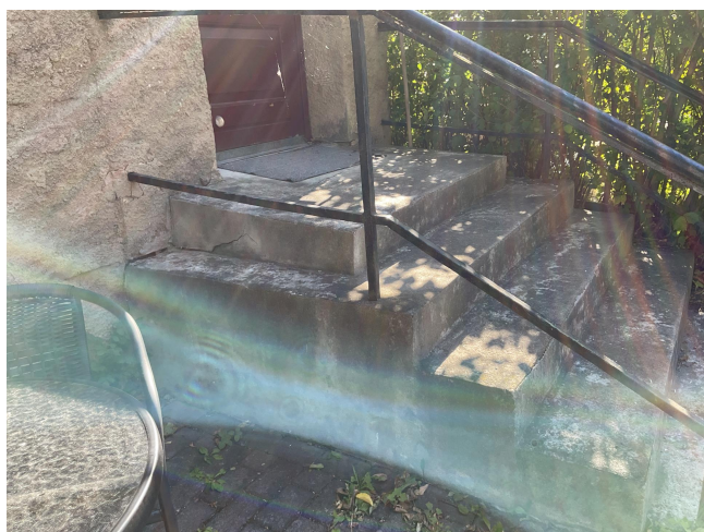
Skjevhet i øvre trappetrinn. Store åpninger i rekkverk.
