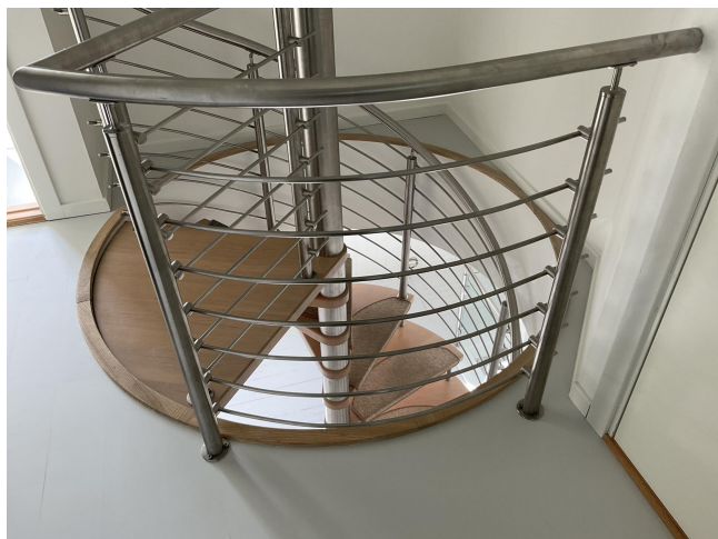
Vindel-trapp og rekkverk tilfredsstillende ikke sikkerhetskrav.
